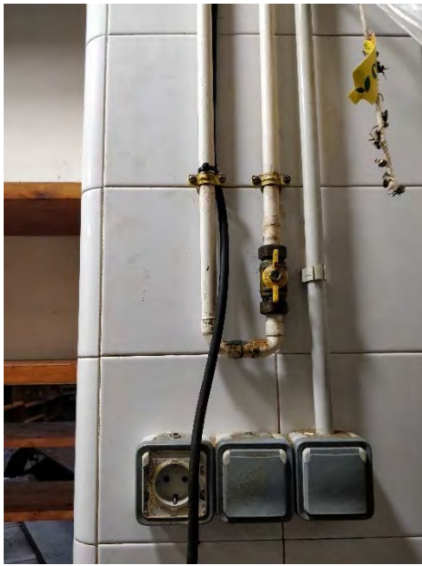
Instal·lacions cuina i quadre comptador elèctric
