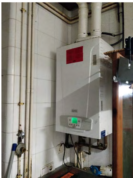
Instal.lacions existents cuina
