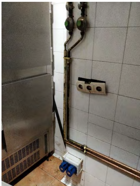
Instal.lacions existents cuina
