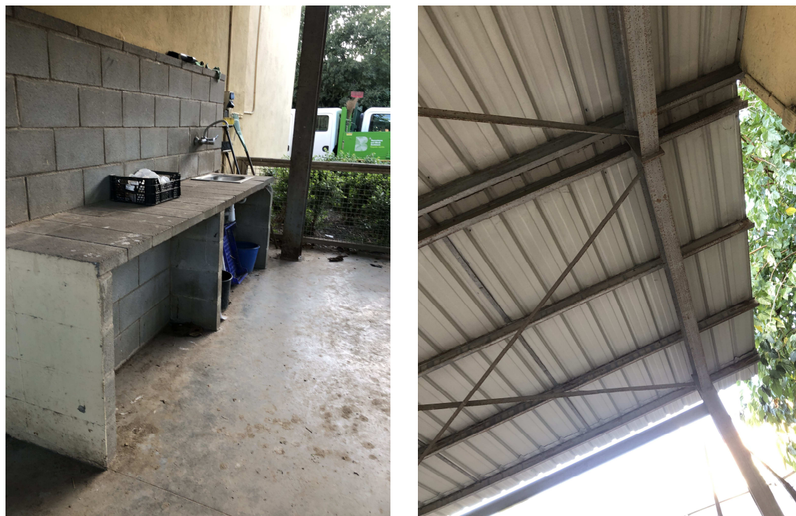
Vista de l'estat de de la zona de cuina i de la coberta de la zona de pràctiques.
