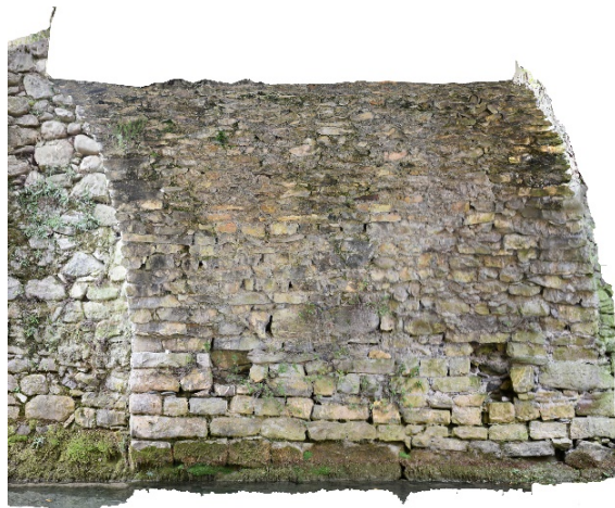
Erosió dels junts per l'acció de l'aigua del riu.
