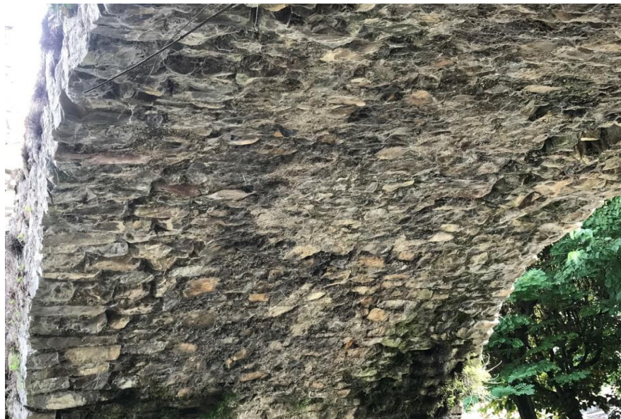
Detall Fisura entre arc i volta. Ull sobre terreny. Arxiu SPAL
