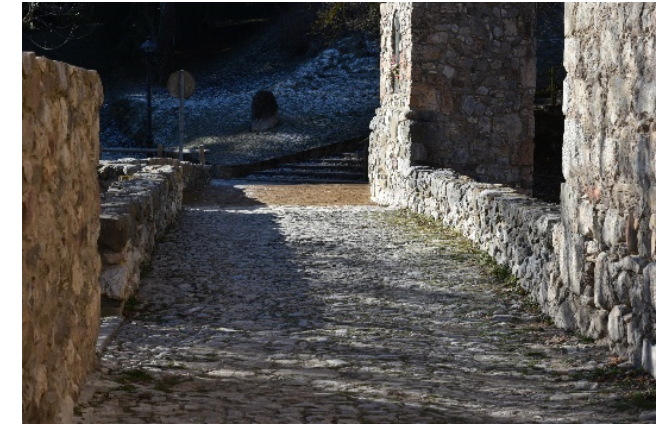
Fotografies del paviment, actual del pont, en segon termin, paviment provisional de sauló
