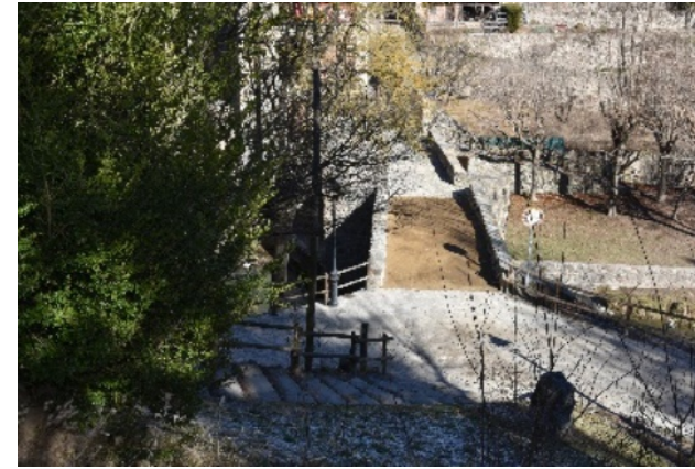
Fotografies del pont després de la primera intervenció, paviment provisional de sauló
