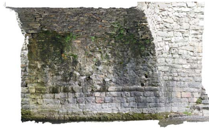
Arc de migdia, pilastra central i volta, afectada per les filtracions del paviment
