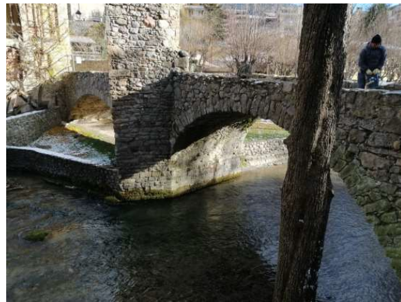
Mur que reconduex les aigües
