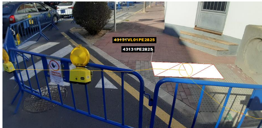
Fig 89. Instal·lació valona 43131VL01PE2825.
