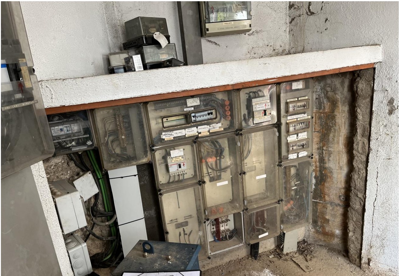
Quadre general ubicat proper a la TMF-10.
