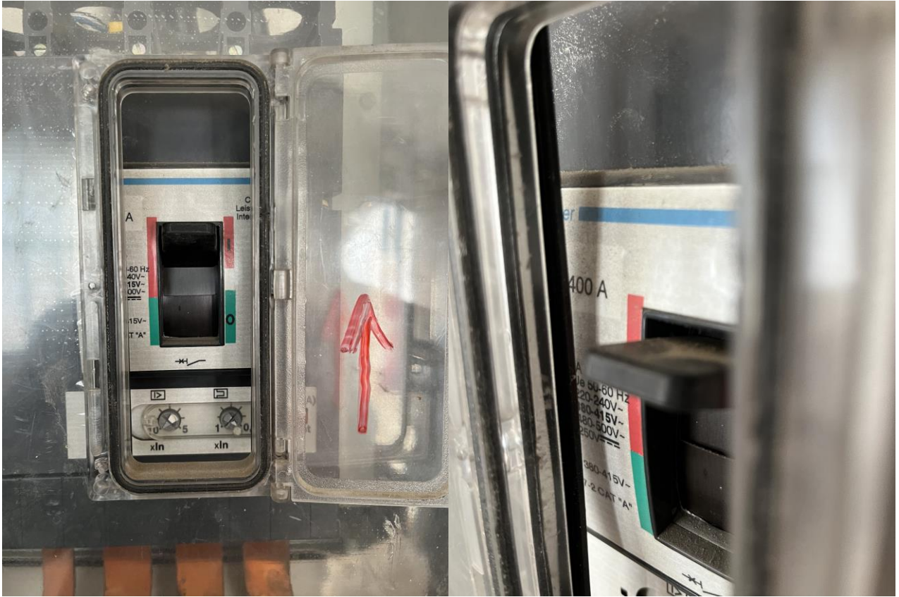
Interrupitor general recinte.
