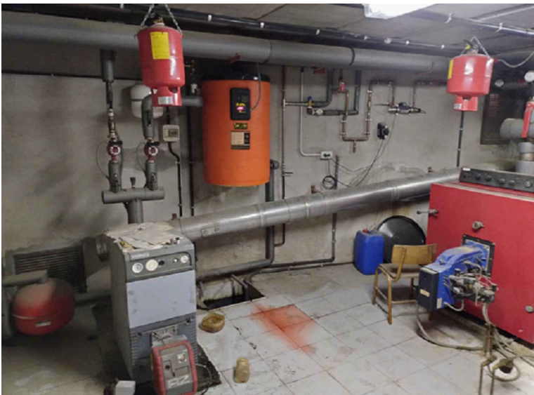
SALA TÉCNICA. CALDERA DE PRODUCCIÓN DE ACS
