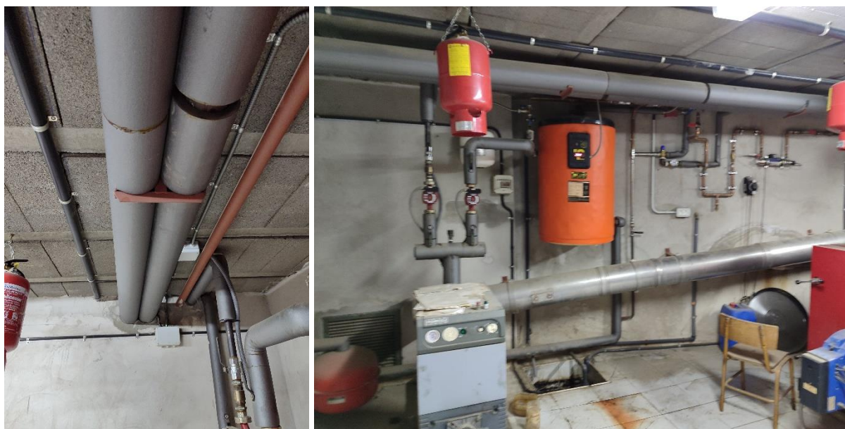
Figura 9. Izq. Tuberías donde se realizarán los picajes. Der. Circuito existente desde calderas
