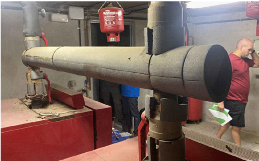
SALA TÉCNICA. COLECTORES DE RETORNO
