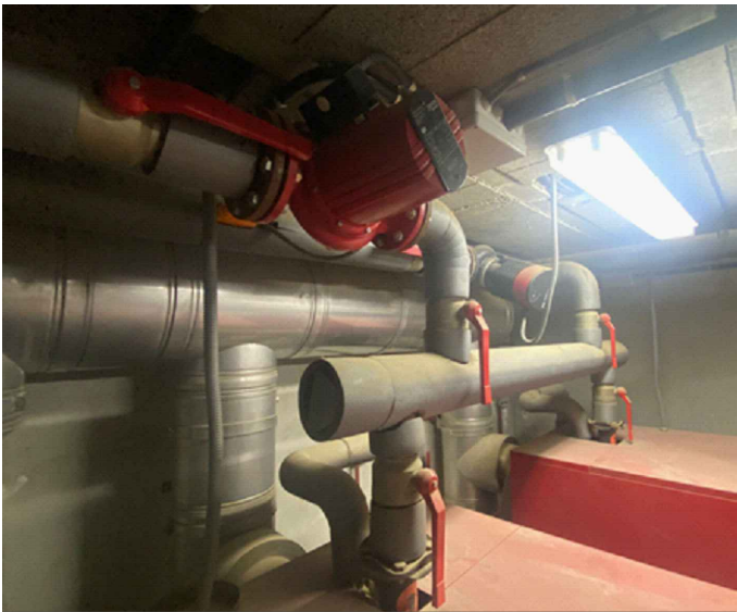
SALA TÉCNICA. COLECTORES DE IMPULSIÓN Y BOMBAS CIRCULADORAS
