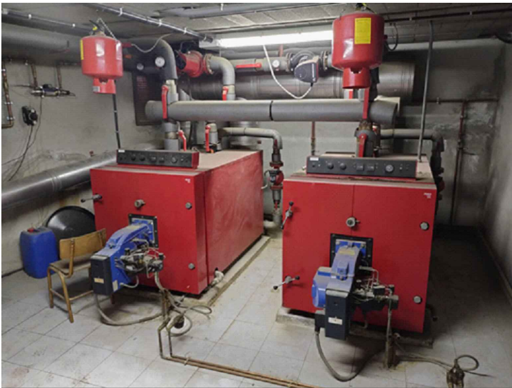
SALA TÉCNICA. CALDERAS EXISTENTES
