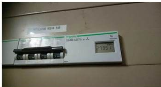
Comptador diferencial elèctric a QG
