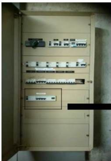
Quadre General elèctric (QG)
