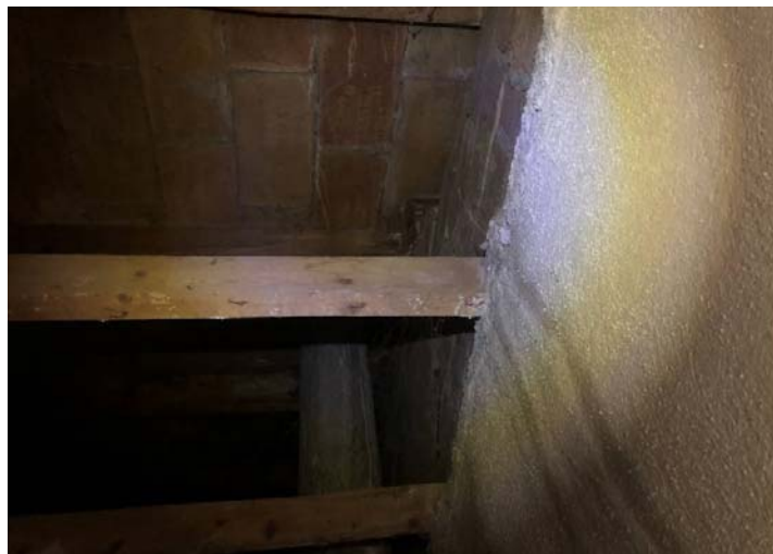
Imatge 11: Parament de paret mitgera entre menjador i aula d'experiències per sobre l'espai de menjador, entre fals sostre i coberta, amb marques d'aigua recurrents.
