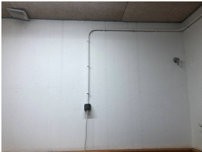
Imatge 09: Paret del fons del menjador de separació amb l'aula d'experiències, amb marques d'escorrenia superficial recurrent sobre la pintura del parament vertical. Instal·lació elèctrica present.
