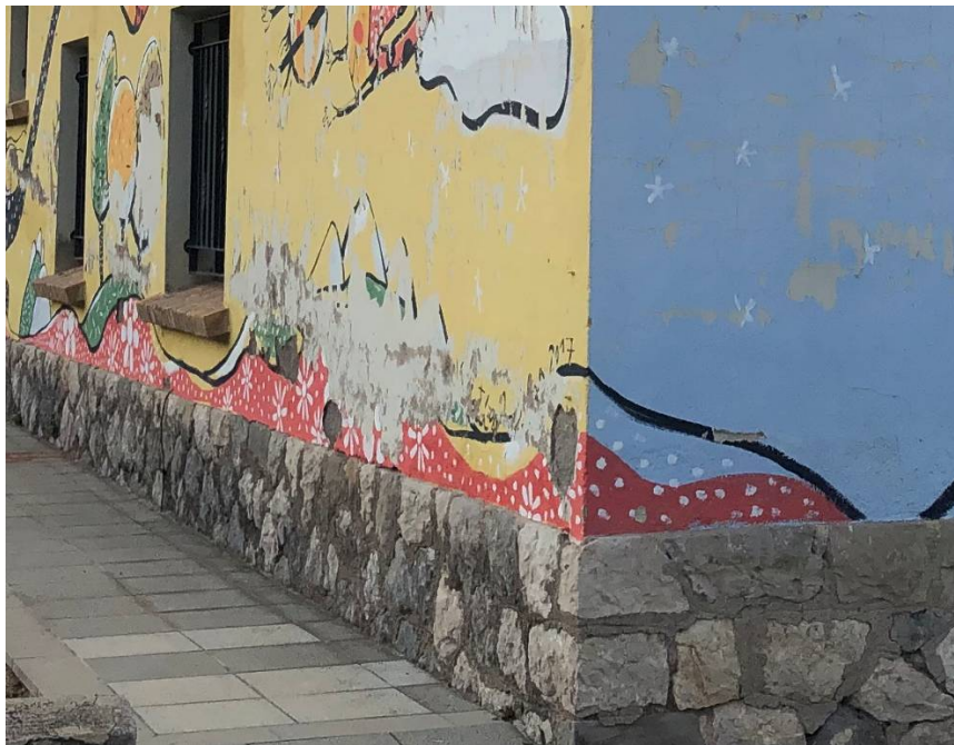
Imatge 21: Revestiment de morter de ciment portland degradat i amb falta d'adherència.
