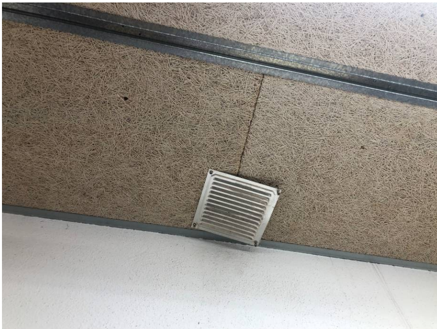
Imatge 19: Fals sostre de fibres degradat amb despreniment de partícules.
