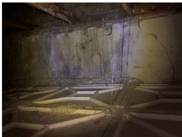
Imatge 15: Humitat d'espai aula d'experiències. Marques d'aigua a parament vertical (revestiment de guix) entre fals sostre de plaques de guix i estructura de sosteniment.
