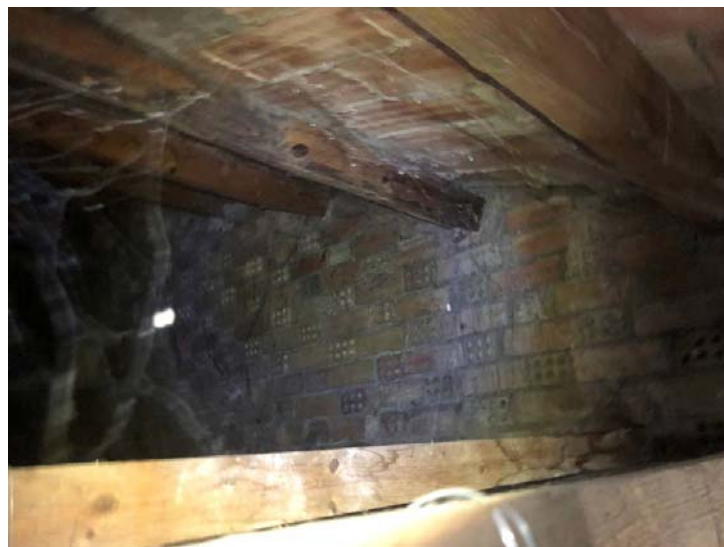
Imatge 14: Humitat d'espai aula d'experiències. Marques d'aigua a elements estructurals de coberta (corretges i estructura auxiliar de fals sostre)
