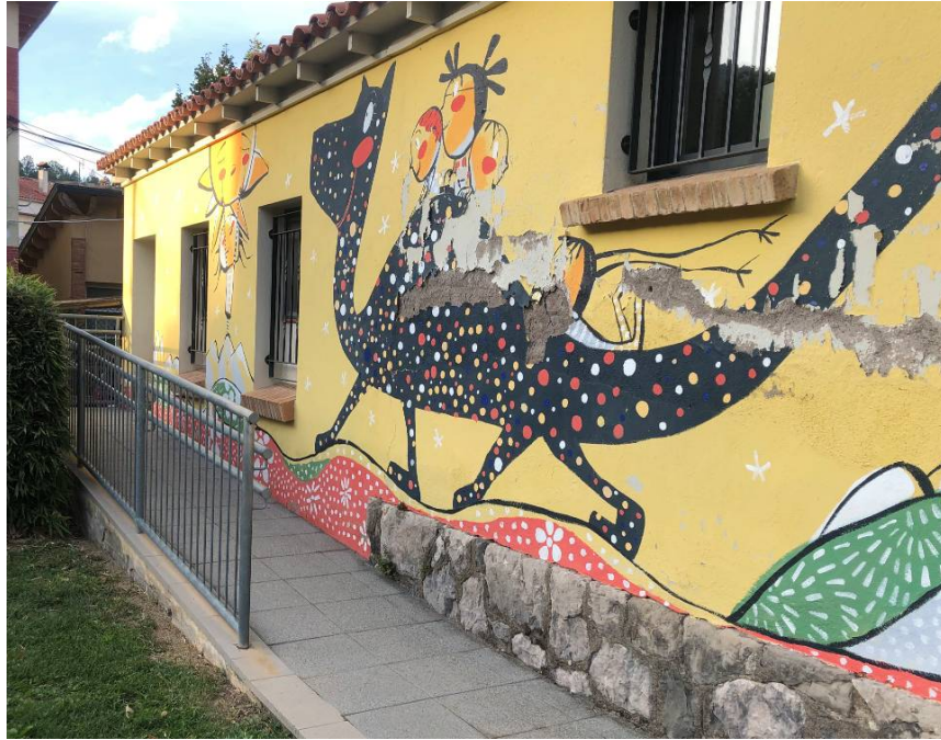
Imatge 20: Revestiment de morter de ciment portland degradat i amb falta d'adherència.
