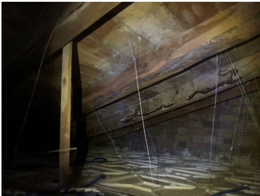
Imatge 17: Humitat sobre l'espai de Llar d'infants. Marques d'aigua a les bigues de coberta. Als espais del costat nord-oest, les bigues van disposades en el sentit del pendent.
