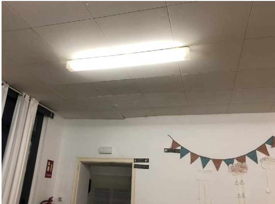
Imatge 16: Humitat d'espai aula d'experiències. Fals sostre deteriorat.
