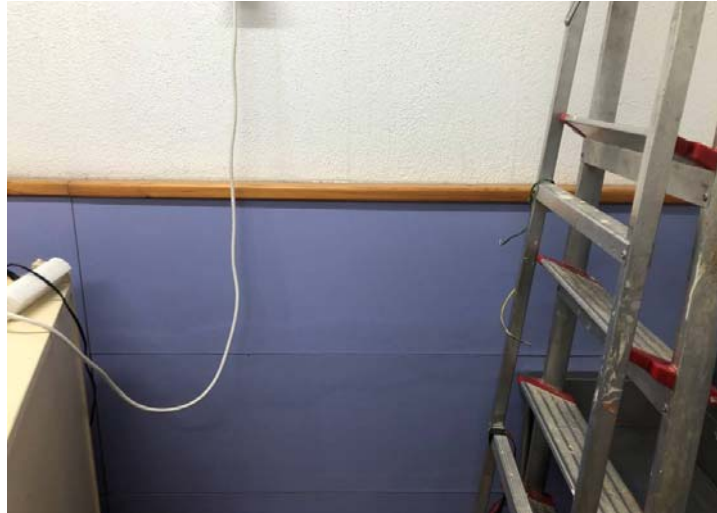
Imatge 10: Panellat fenòlic de resguard de parament a menjador rebufat perimetralment per humitats recurrents.
