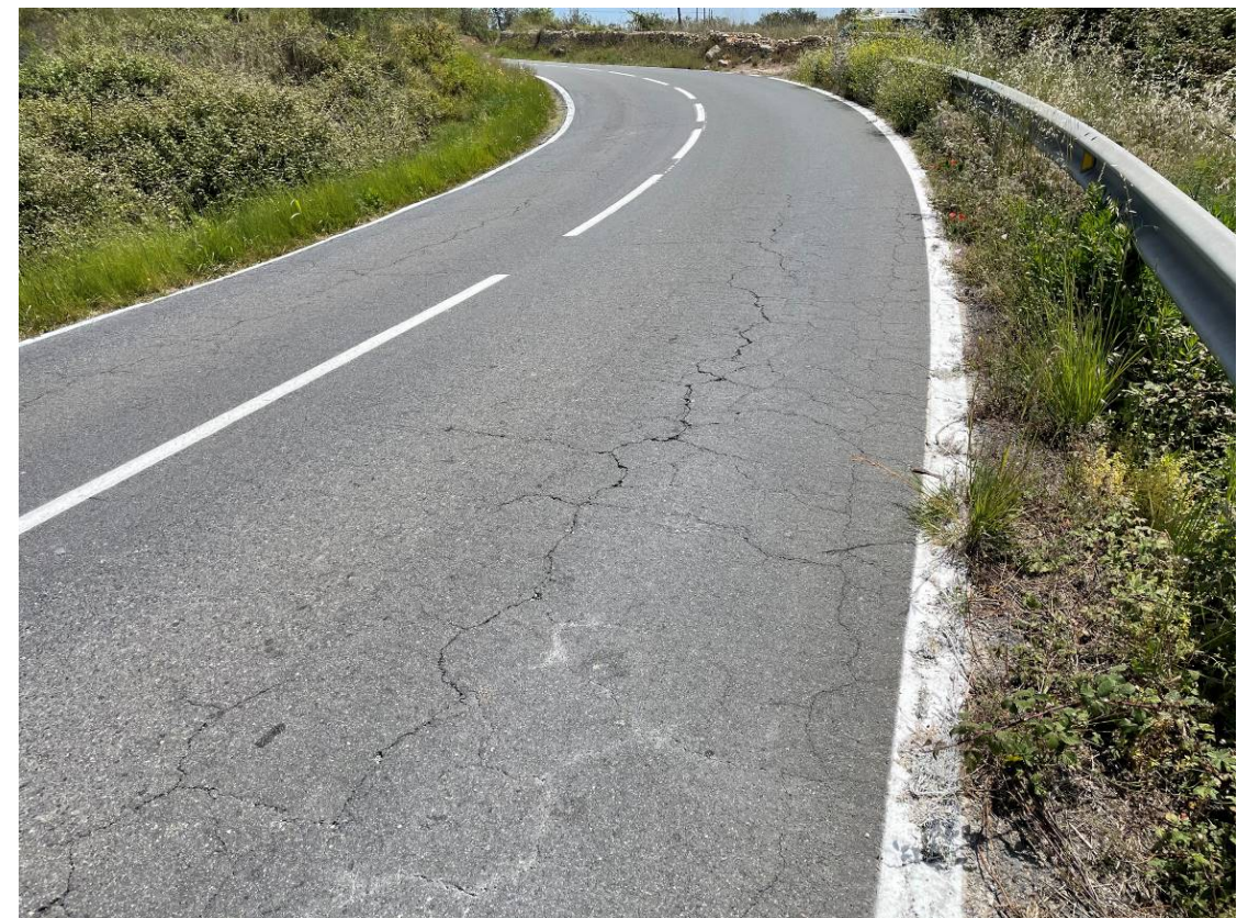
FOTOGRAFIA 20. Estat de l'asfalt i localització de cuneta.
