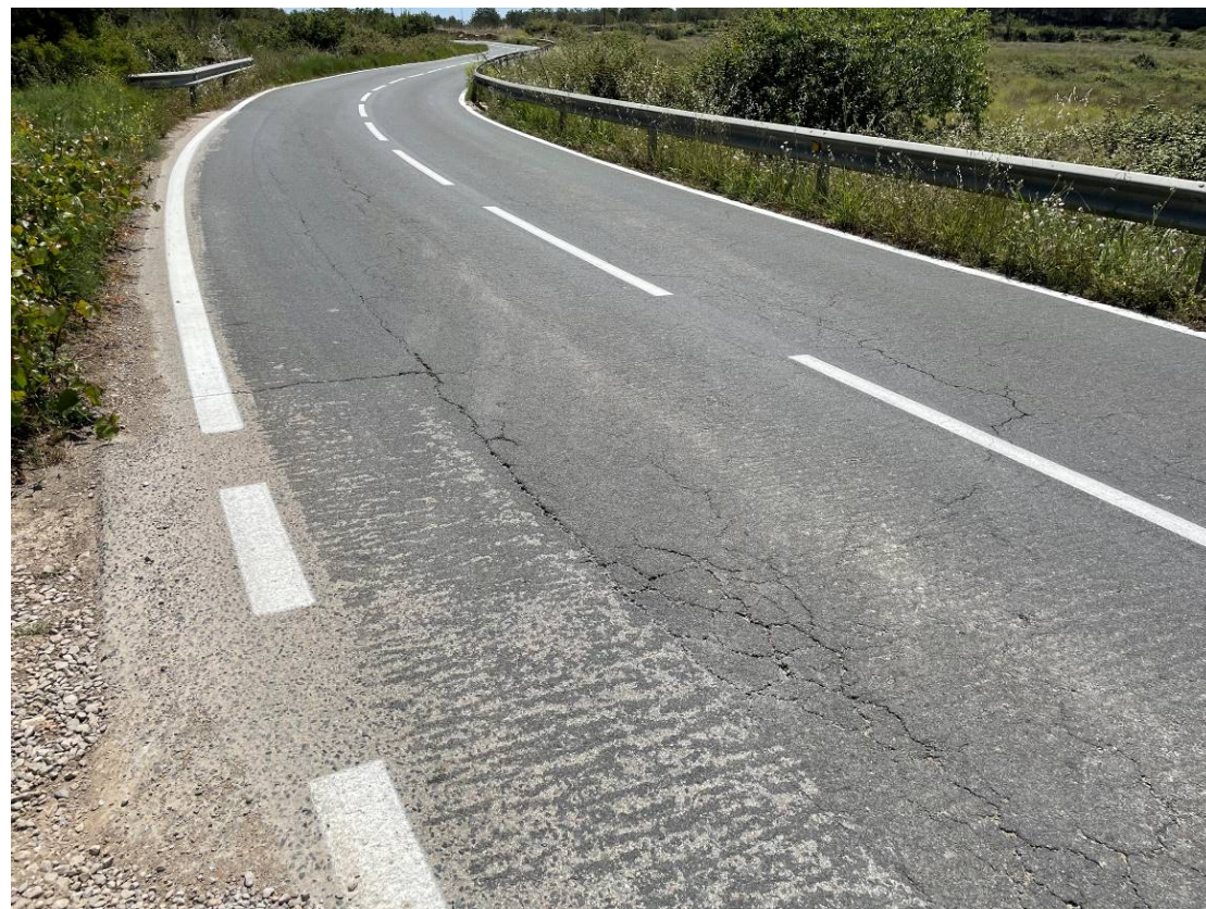
FOTOGRAFIA 18. Estat de l'asfalt i localització de cuneta.
