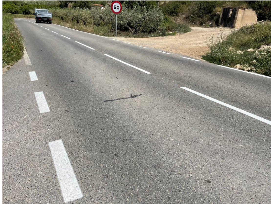
FOTOGRAFIA 1. Estat de l'asfalt existent i localització de gual de cuneta.
