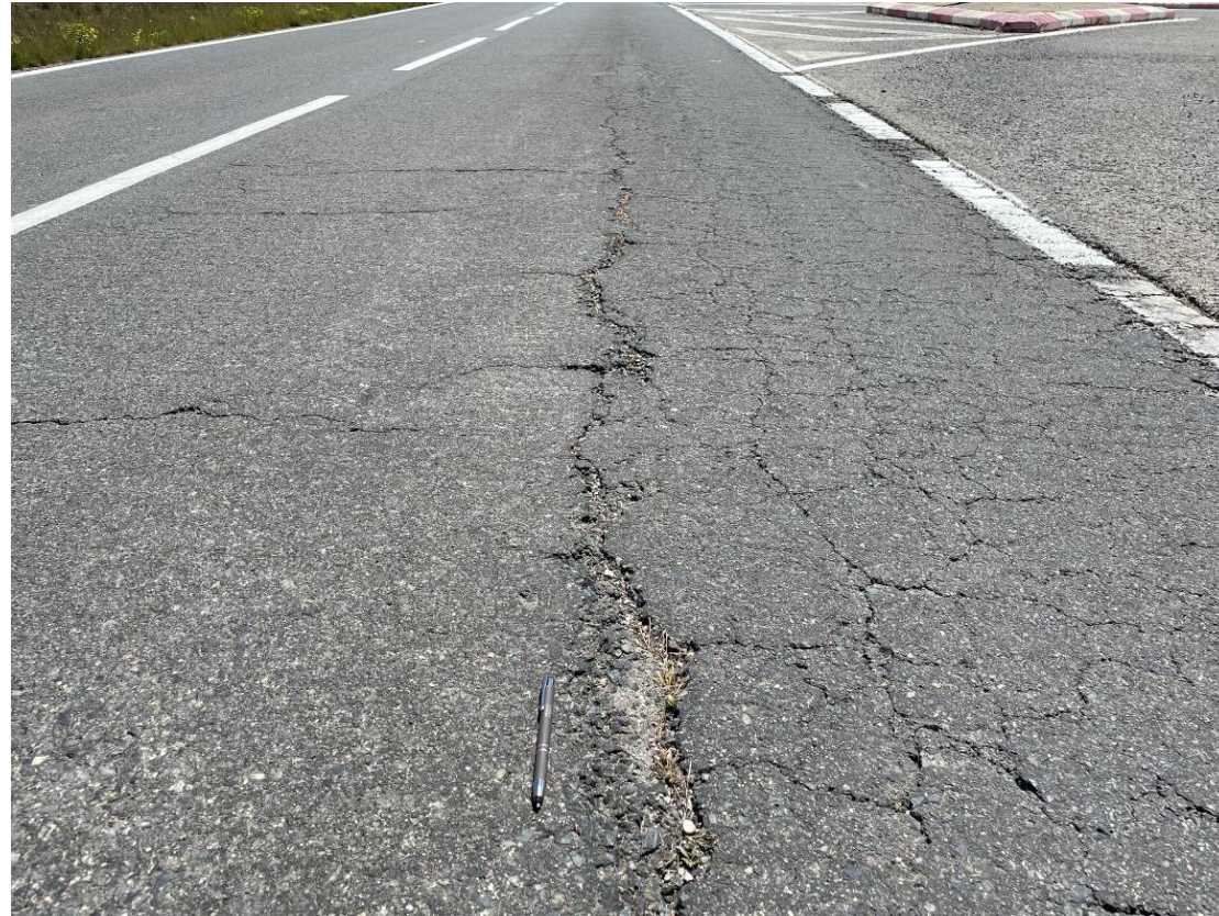
FOTOGRAFIA 9. Estat de l'asfalt.
