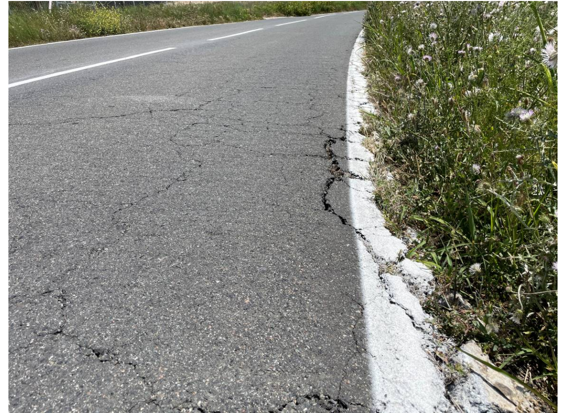
FOTOGRAFIA 19. Estat de l'asfalt i localització de cuneta.
