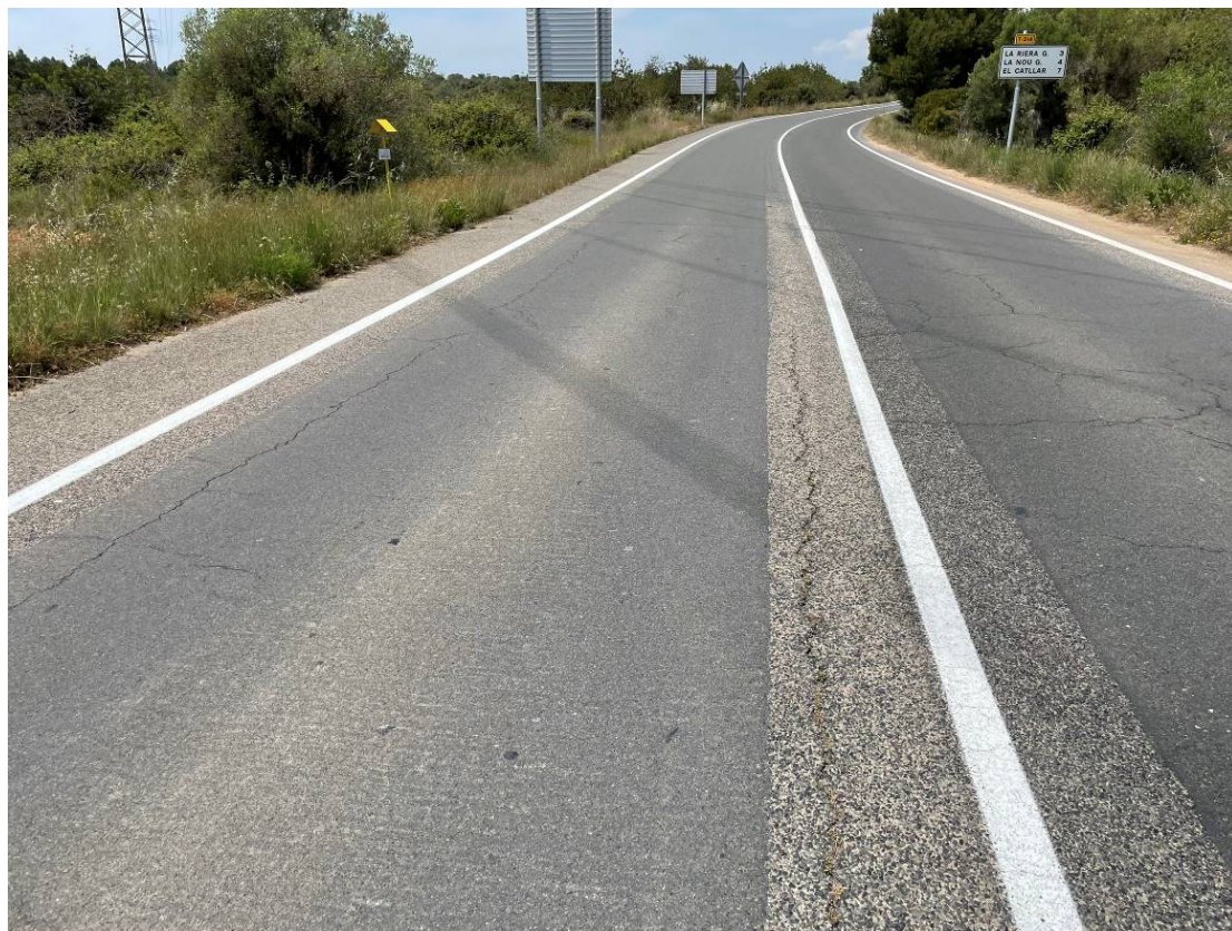
FOTOGRAFÍA 30. Estat de l'asfalt.
