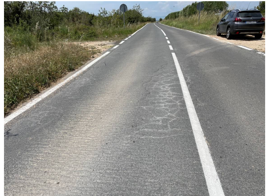
FOTOGRAFIA 28. Estat de l'asfalt i localització de cuneta.
