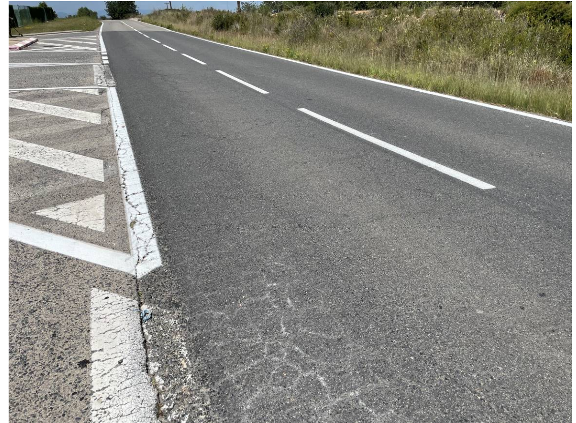
FOTOGRAFIA 11. Estat de l'asfalt i localització de cuneta.
