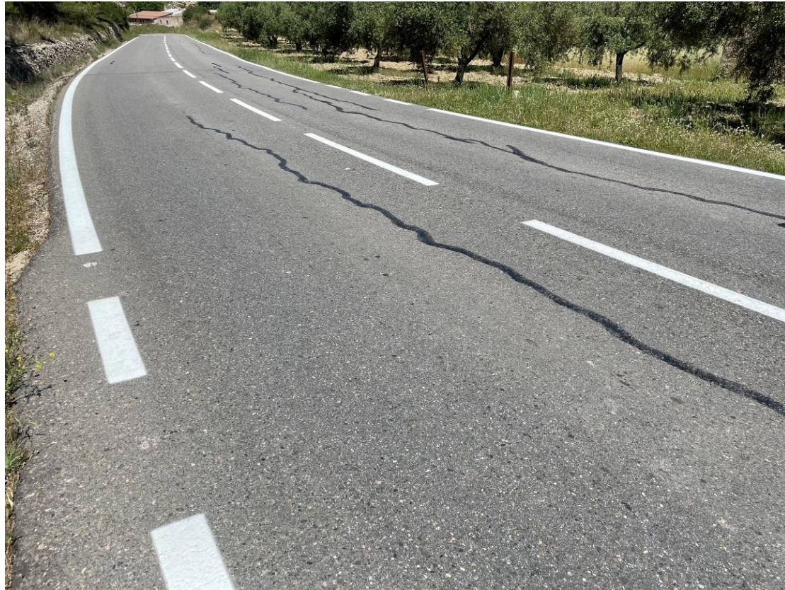
FOTOGRAFIA 5. Estat de l'asfalt i localització de cuneta.
