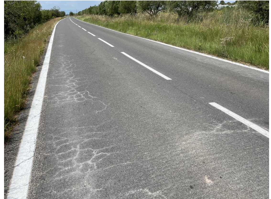
FOTOGRAFIA 27. Estat de l'asfalt i localització de cuneta.
