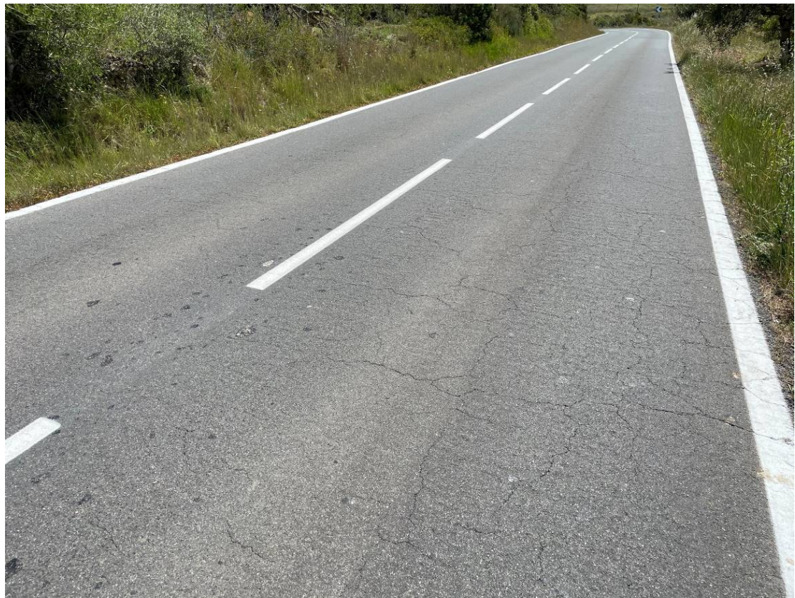
FOTOGRAFIA 13. Estat de l'asfalt i localització de cuneta.
