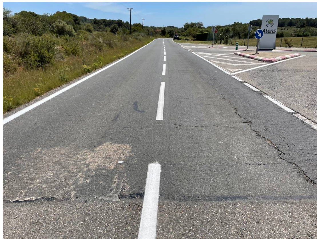
FOTOGRAFIA 10. Estat de l'asfalt i localització de cuneta..
