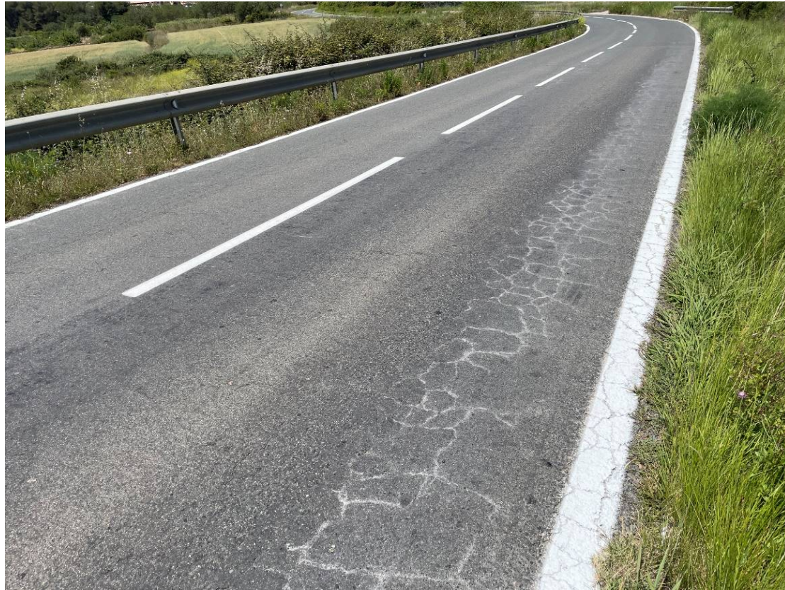
FOTOGRAFIA 21. Estat de l'asfalt i localització de cuneta.
