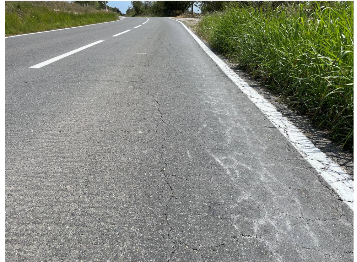
FOTOGRAFIA 23. Estat de l'asfalt i localització de cuneta.
