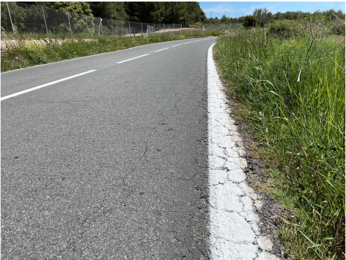
FOTOGRAFIA 15. Estat de l'asfalt i localització de cuneta.
