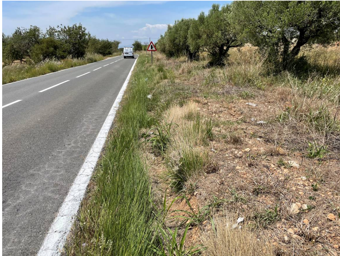
FOTOGRAFIA 25. Estat de l'asfalt i localització de cuneta.
