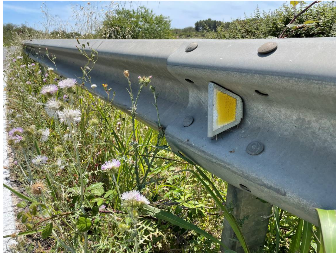
FOTOGRAFIA 17. Tipologia de barrera existent a ser renovada.
