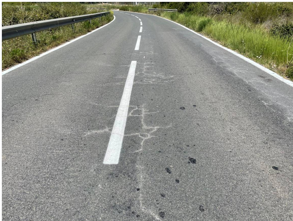
FOTOGRAFIA 22. Estat de l'asfalt i localització de cuneta.
