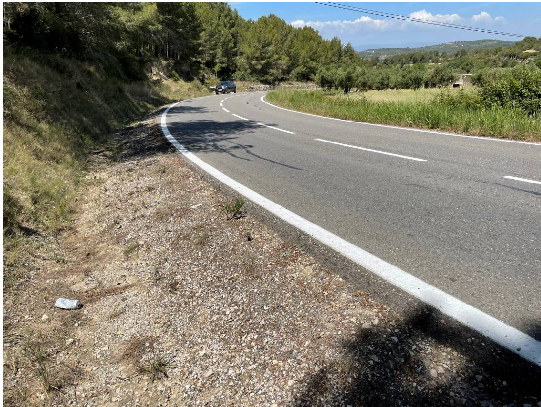
FOTOGRAFIA 6. Estat de l'asfalt existent.
