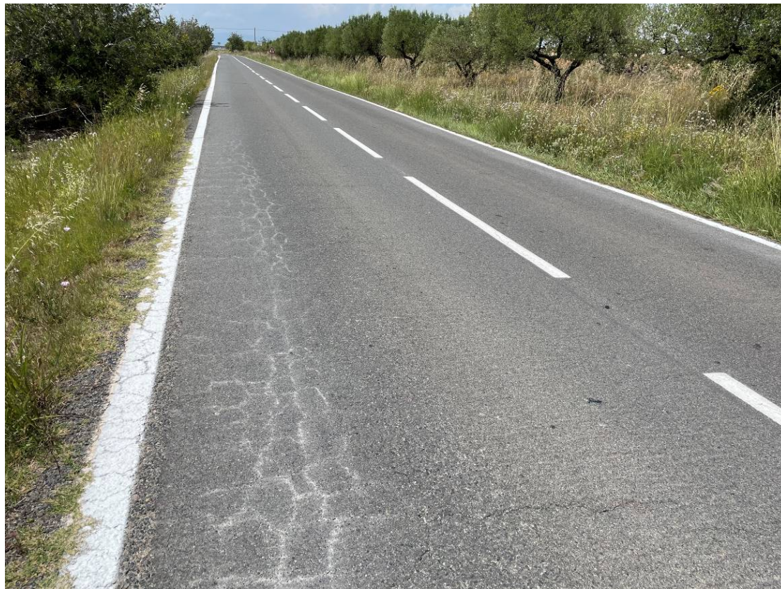
FOTOGRAFIA 26. Estat de l'asfalt i localització de cuneta.
