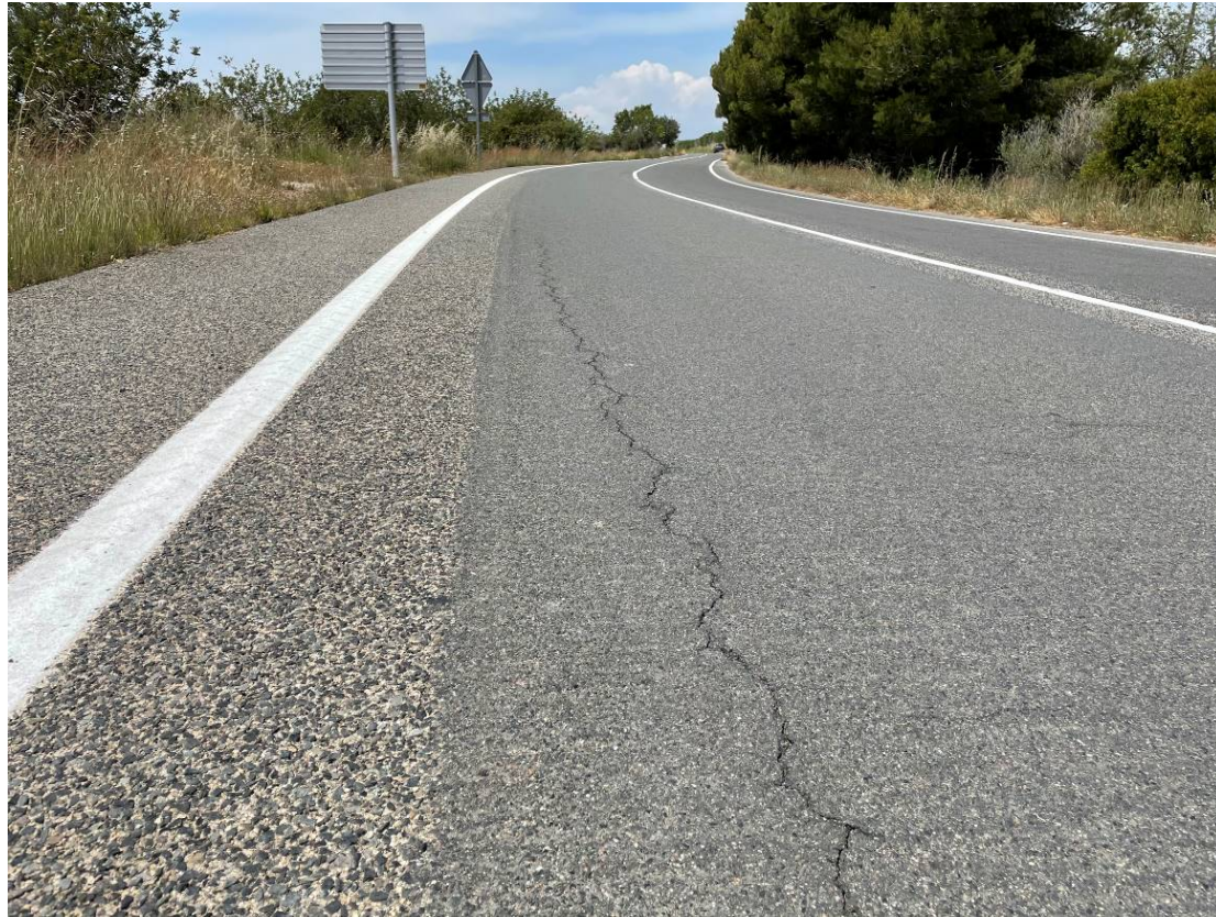
FOTOGRAFIA 29. Estat de l'asfalt.
