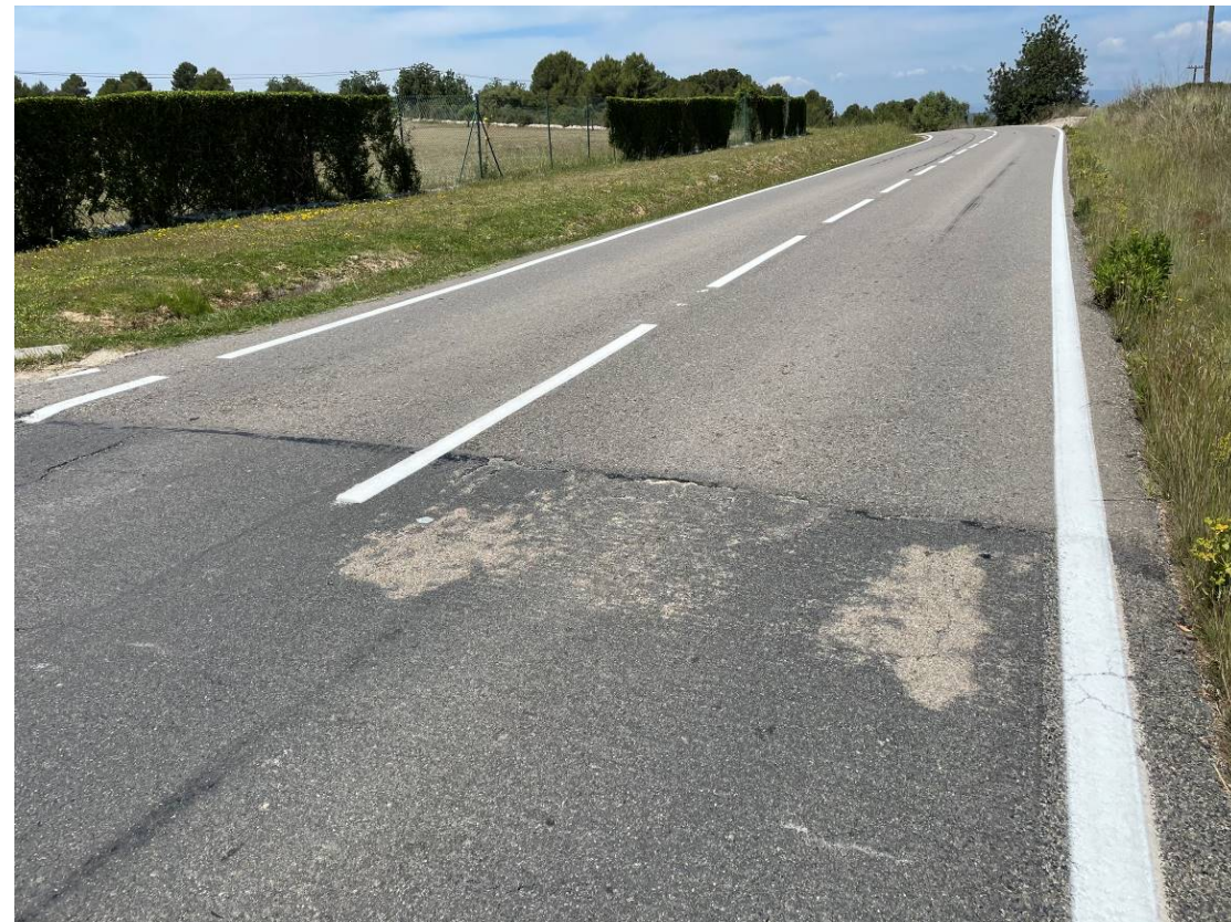
FOTOGRAFIA 8. Estat de l'asfalt i localització de cunetes.
