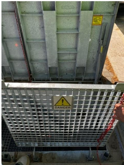
Fig. 1. Tapa d'accés a la sala d'equipaments, amb sistema de bloqueig a 90° i amb reixeta de seguretat.
