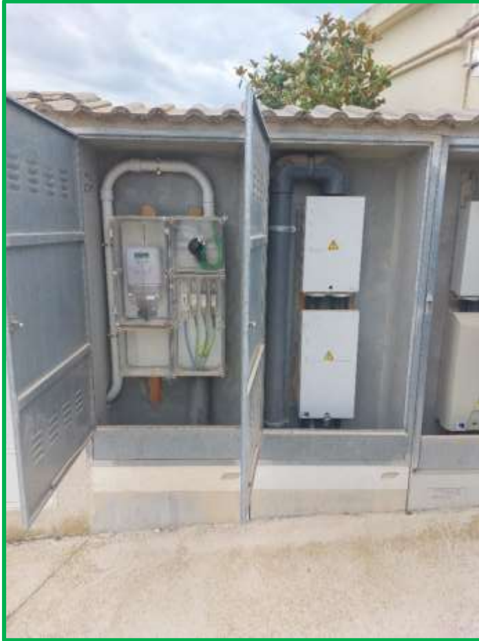
3.- Quadre electric general i comptador
