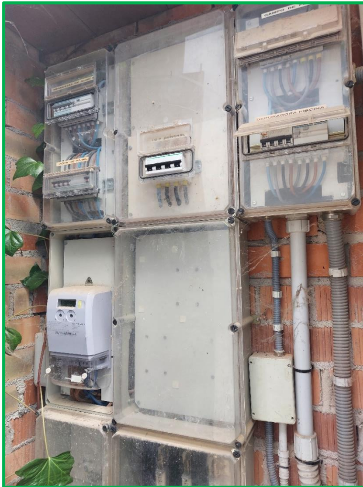
3.- Quadre electric general i comptador
