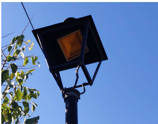
Fig. 1.- Luminaria tipo Villa ubicada en los diversos núcleos del municipio de Castell de Mur
