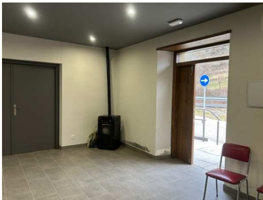
Imatge 01. Fissura sobre la porta i humitats en el sostre del tanatori d'Escaló.
