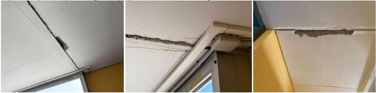
Fotos estat actual dels junts de dilatació
