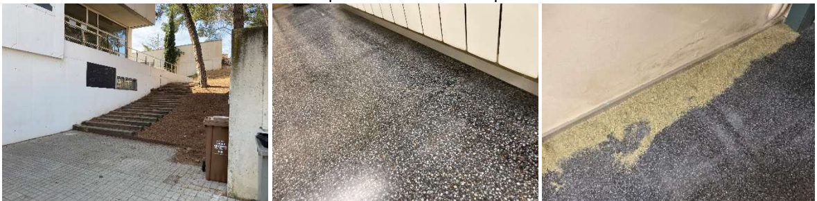
Fotos de l'exterior i l'interior dels despatxos d'administració. Part baixa del mur on apareixen humitats.
