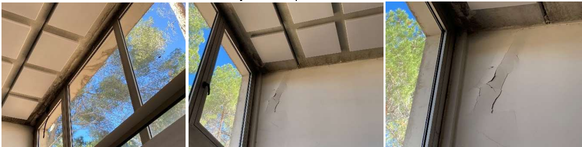
Fotos de les floridures interiors i del i escrostonaments de la pintura
