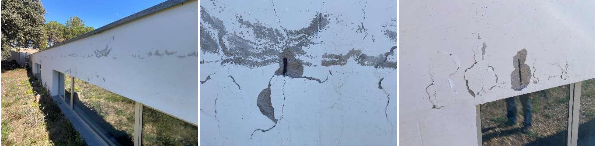
Fotos de l'exterior del mur on l'escàs recobriment i la degradació de la pintura provoquen l'oxidació de les armadures
