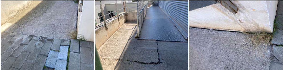
Fotos estat actual del paviment on s'observen esquerdes, desnivells i junts oberts.
