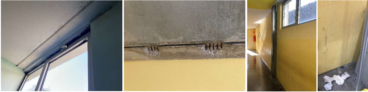
Fotos de les humitats del sostre, amb punts d'oxidació de les armadures, i del baixant interior que provoca humitats.
