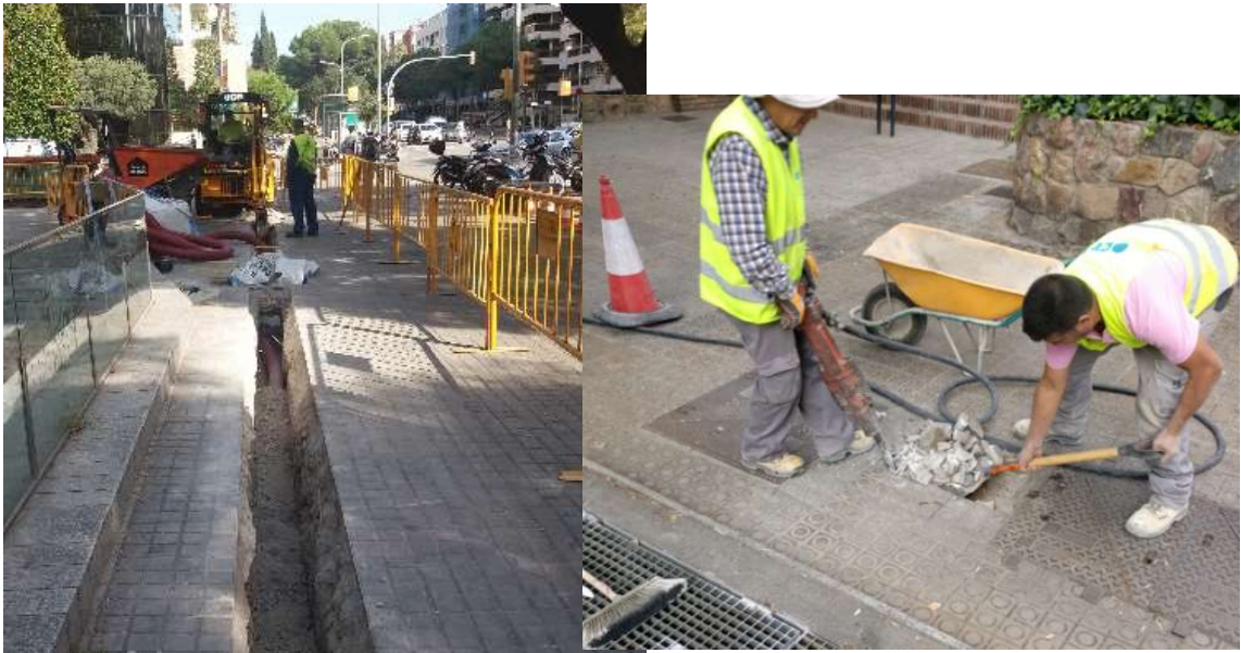
Exemples Canalització Convencional en àmbit municipal.
