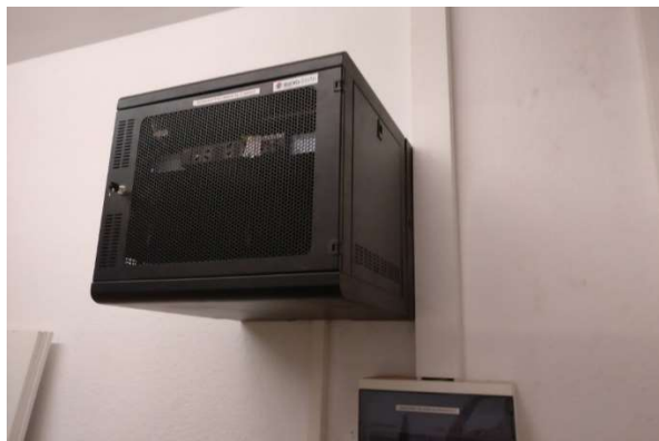
Exemple d'instal·lació de Rack de Comunicacions dins de seu de client.
