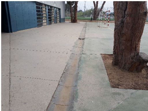
Canaleta zona pista esportiva
