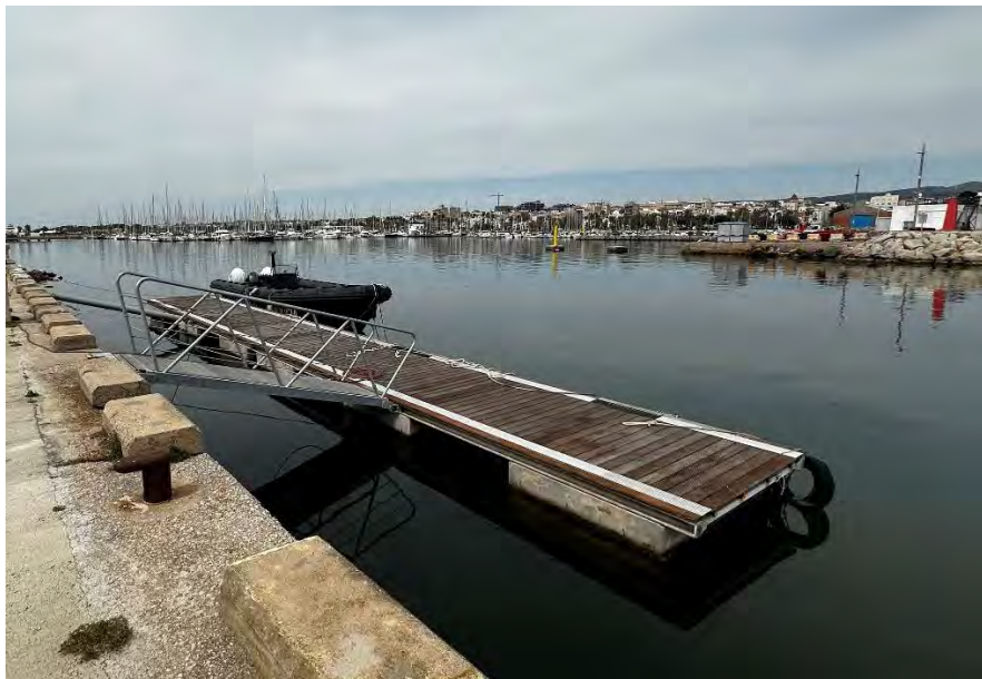
Imatge 2. Estat actual del pantalà flotant instal·lat al moll transversal.
