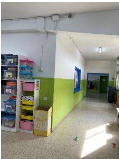
Ubicació per Boca incendis en PB edifici escola PAS2
