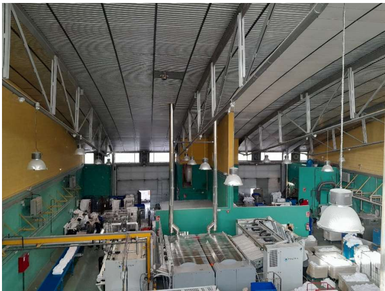
Imatge 5. Vista general de la nau (zona procés), on al fons es poden observar els extractors murals de façana.
