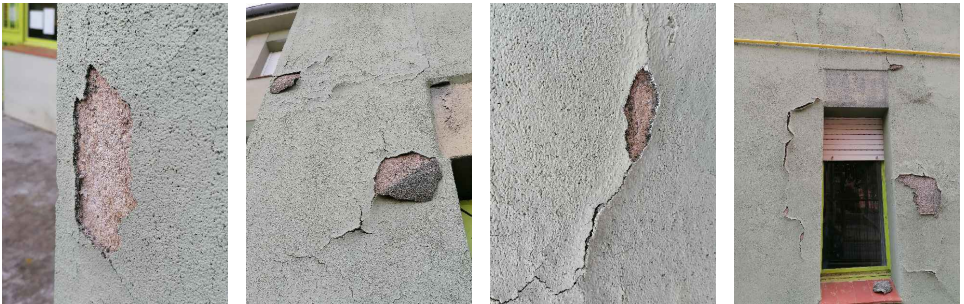
PATOLOGIES AL REVESTIMENT EXTERIOR
