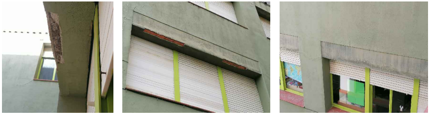
PATOLOGIES A LES CAIXES DE PERSIANES
