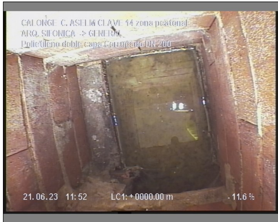
Foto: 1_1_1_21062023_115250_A.JPG 0m, Obstáculo por sedimentaciones desde 12 hasta 12 horas. Reducción de sección 0 %
