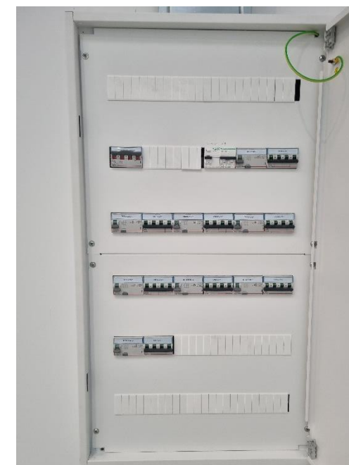
Subquadre punts de recàrrega existent
