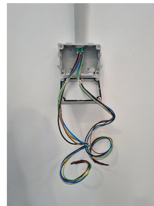
Caixes amb cablejat circuits de recàrrega existent
