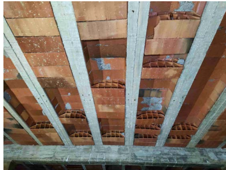
F19 - Revoltos trencats, fissurats o en risc de caiguda
