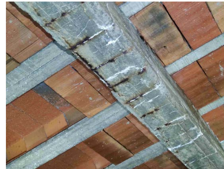
F32 - Oxidació d'estreps per manca de recobriment en cara inferior de la jàssera
