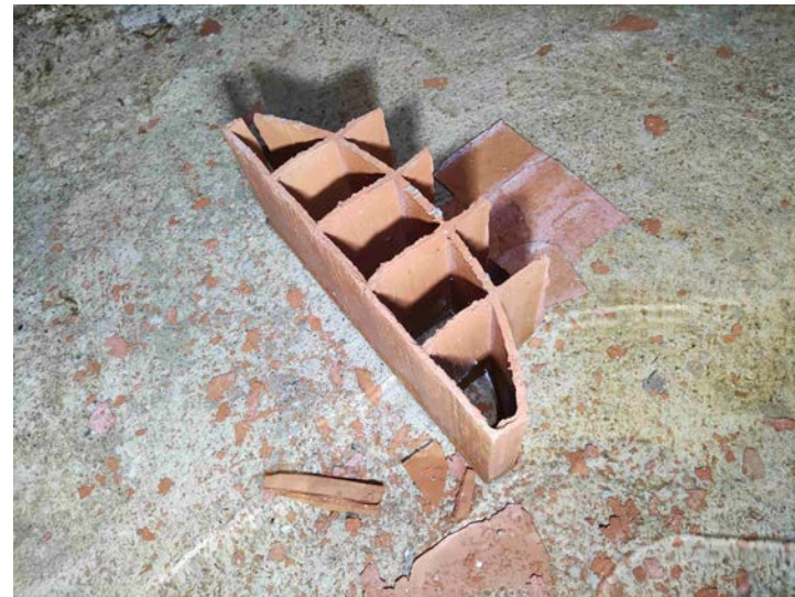
F20 - Revoltos trencats i caiguts sobre la solera
