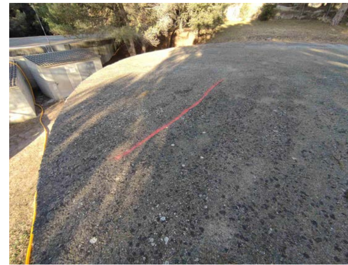
F28 - Senyalització amb spray de la situació de fissura en la capa de compressió de coberta.
