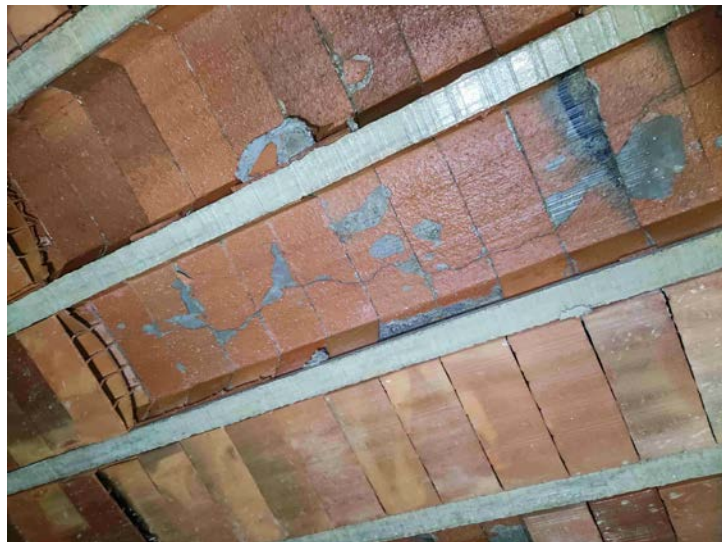
F22 - Vista interior de fissura en la capa de compressió de coberta. Absència de revoltos per trencament i despreniment
