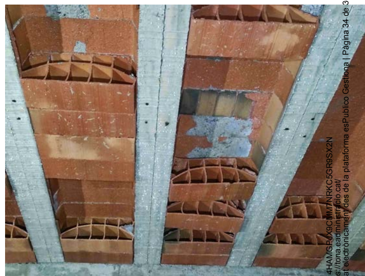
F35 - Punts d'oxidació en ales inferiors de biguetes prefabricades
