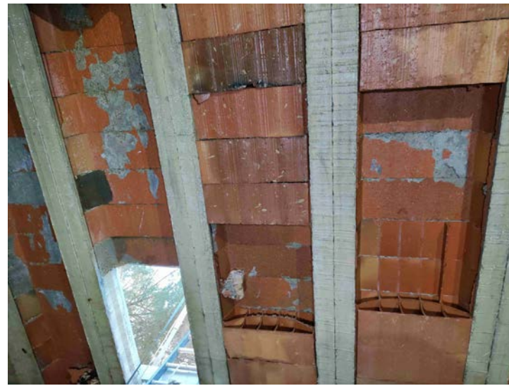
F15 - Revoltos trencats, fissurats o en risc de caiguda
