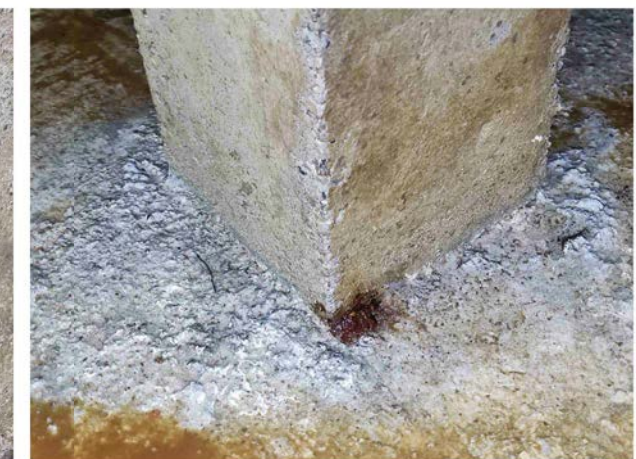
F13 - Punt d'xidació a la basa d'un pilar
