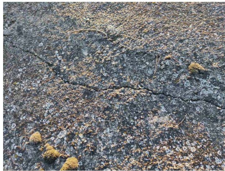
F27 - Fissura en la capa de compressió de coberta. Amb presència de vegetació arrelada
