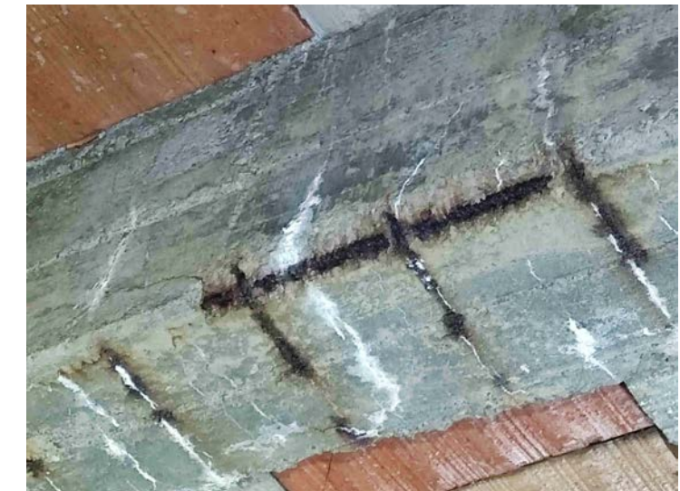
F33 - Oxidació d'estreps per manca de recobriment en cara inferior de la jàssera
