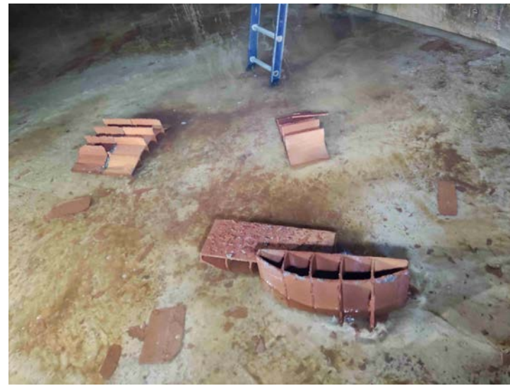
F16 - Revoltos trencats i caiguts sobre la solera
