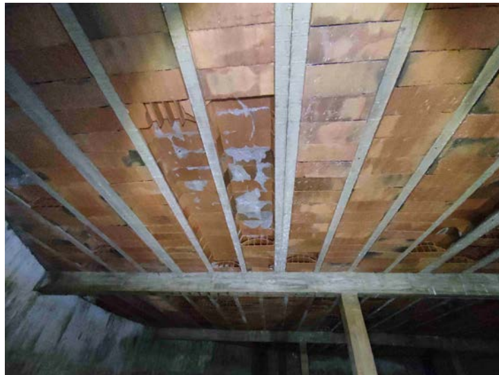
F18 - Revoltos trencats, fissurats o en risc de caiguda. Esquerda en capa de compressió de coberta
