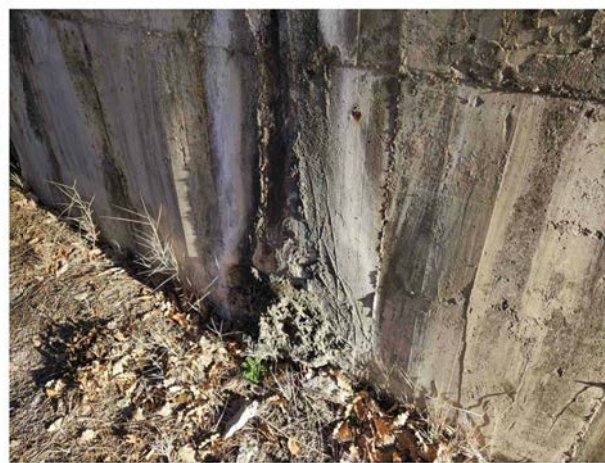
F02 - Filtracions verticals en trams del mur exterior. Detall
