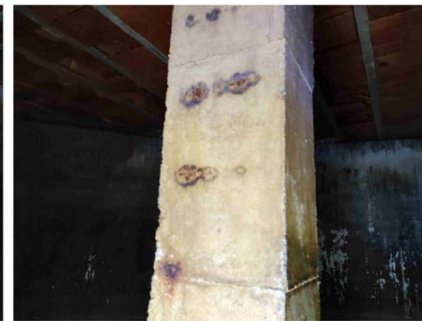
F09 - Coques i punts d'oxidació en cara d'un pilar
