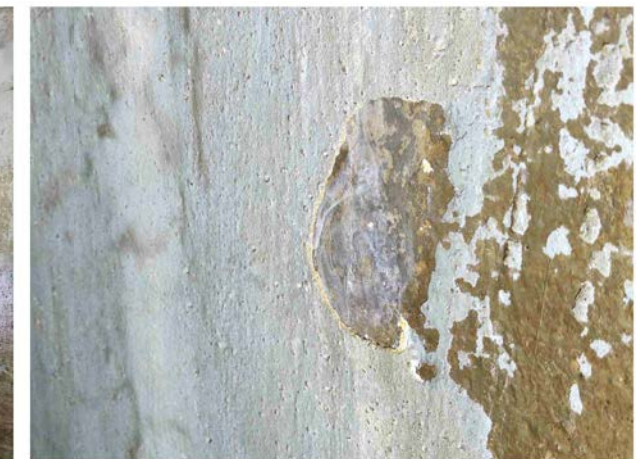
F07 - Filtracions verticals en trams interiors dels murs. Desprement
