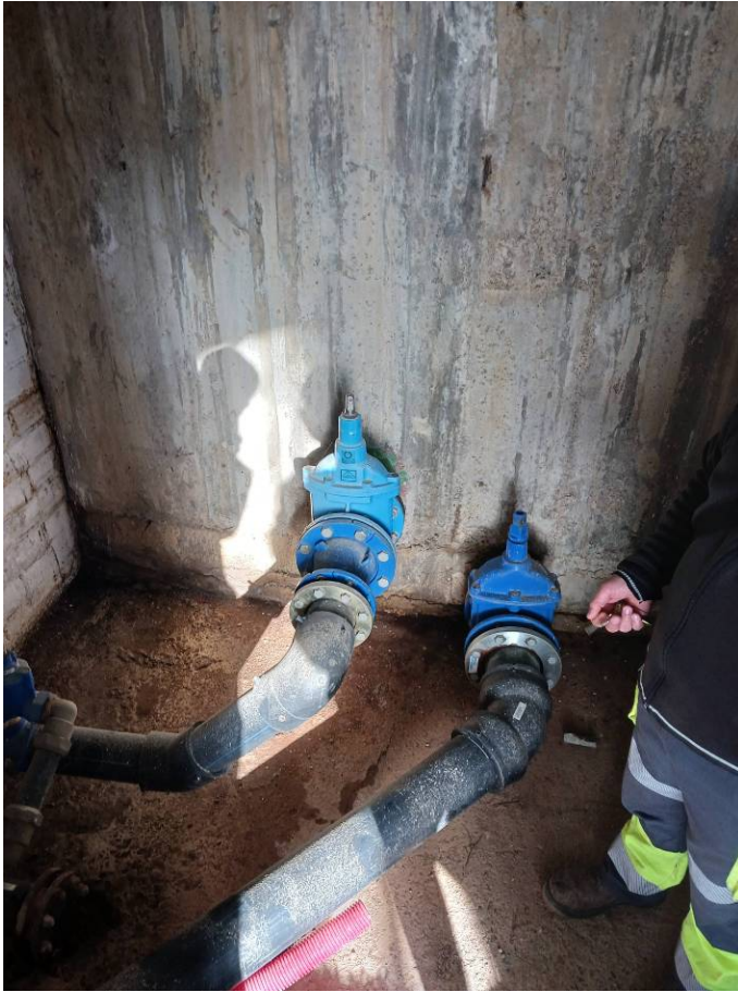
Caseta de vàlvules interior
