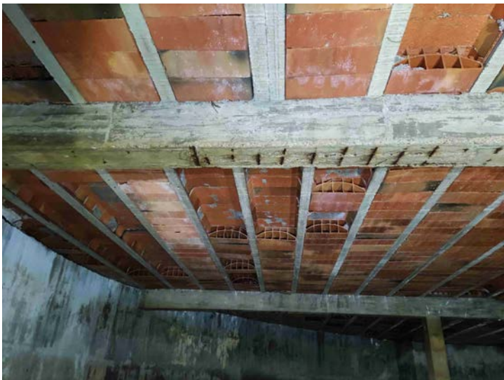
F30 - Oxidació d'estreps per manca de recobriment en cara inferior de la jàssera
