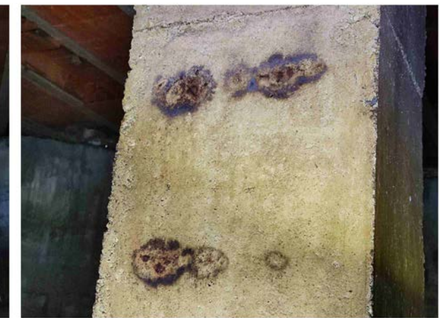
F10 - Coques i punts d'oxidació en cara d'un pilar. Detall
