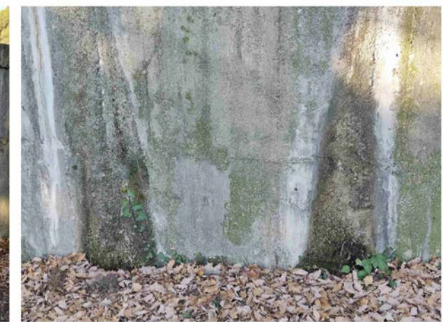
F04 - Filtracions verticals en trams del mur exterior. Detall
