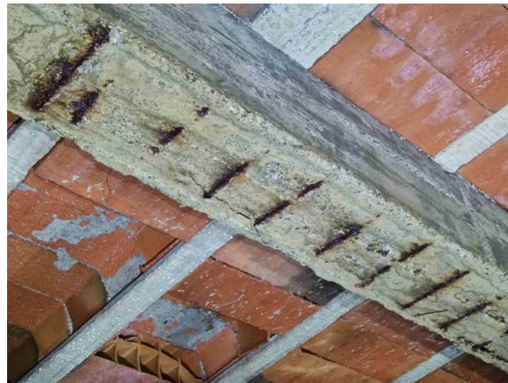
F31 - Oxidació d'estreps per manca de recobriment en cara inferior de la jàssera
