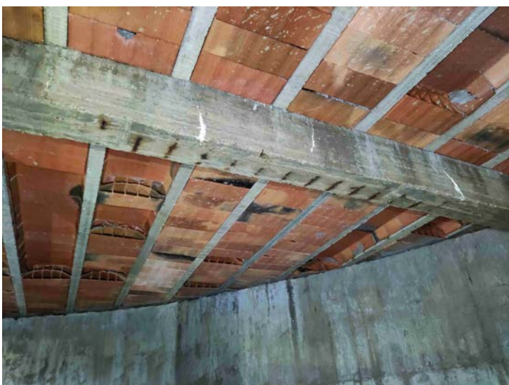
F34 - Oxidació d'estreps per manca de recobriment en cara inferior de la jàssera
