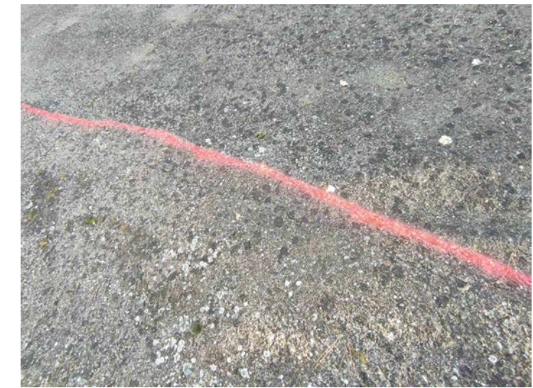
F29 - Senyalització amb spray de la situació de fissura en la capa de compressió de coberta.
