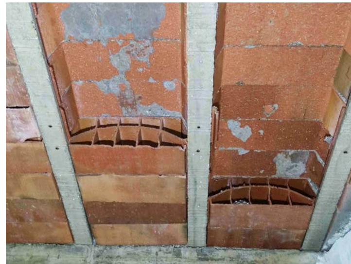
F24 - Vista interior de fissura en la capa de compressió de coberta. Absència de revoltos per trencament i despreniment
