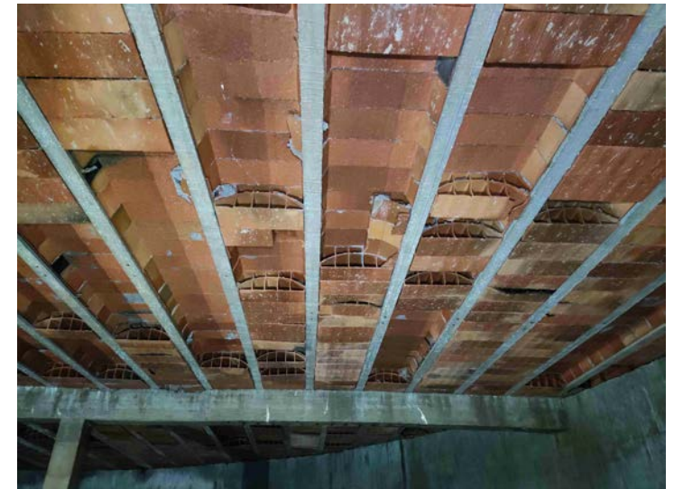
F21 - Revoltos trencats, fissurats o en risc de caiguda
