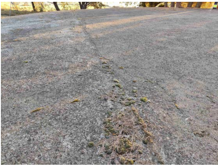
F26 - Fissura en la capa de compressió de coberta. Amb presència de vegetació arrelada
