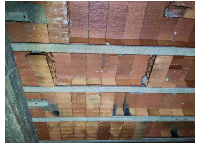
F25 - Vista interior de fissura en la capa de compressió de coberta. Absència de revoltos per trencament i despreniment
