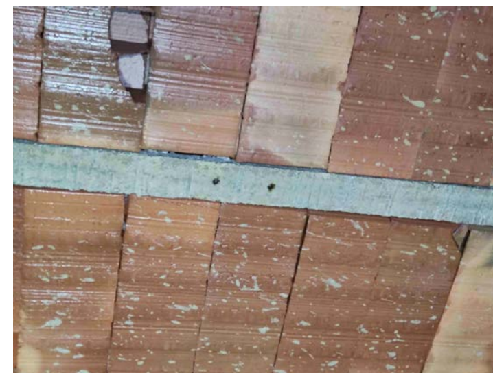
F36 - Punts d'oxidació en ales inferiors de biguetes prefabricades
