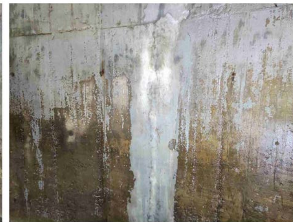
F06 - Filtracions verticals en trams interiors dels murs. Detall
