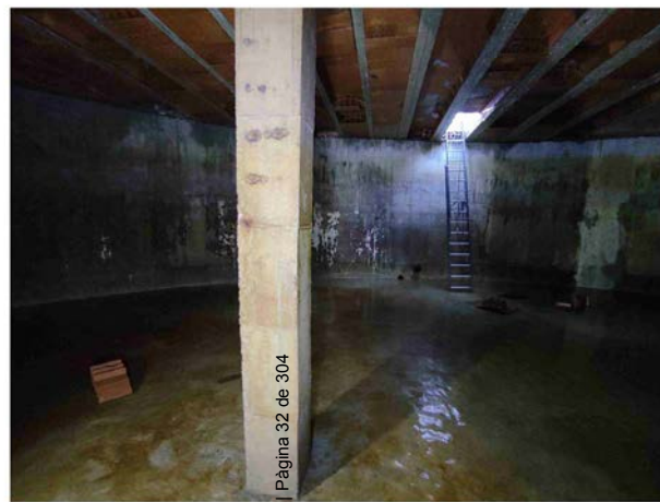
F08 - Coques i punts d'oxidació en cara d'un pilar
