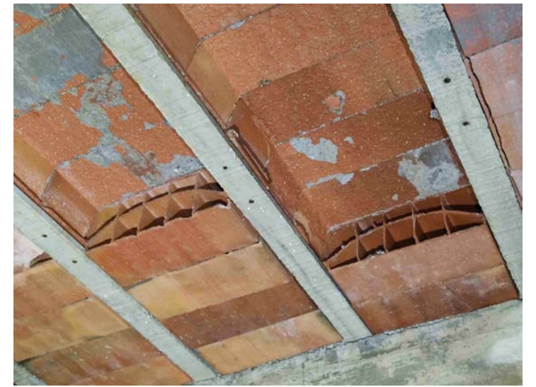
F17 - Revoltos trencats, fissurats o en risc de caiguda
