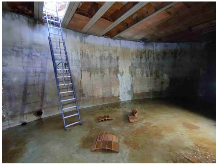
F14 - Revoltos trencats i amb caiguda, en zona d'accés al dipòsit
