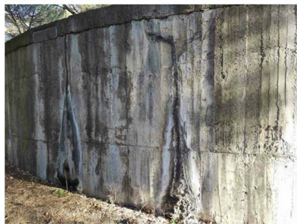
F01 - Filtracions verticals en trams del mur exterior
