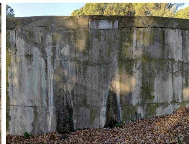
F03 - Filtracions verticals en trams del mur exterior
