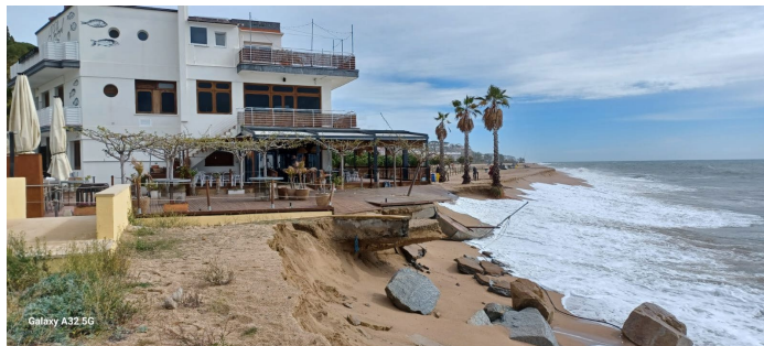
Imatge 16: Visió de la platja des del passeig de llevant. Col·lapse mur contenció i terrassa. Data 31.03.2024.
