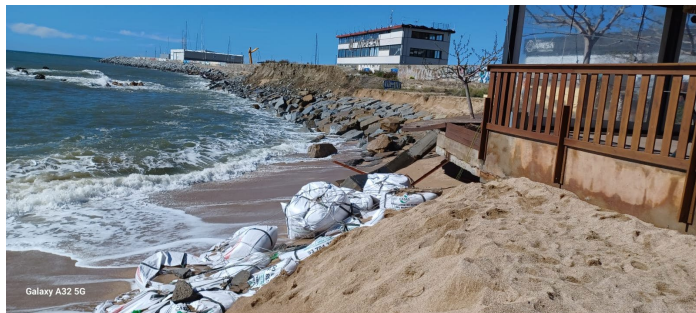
Imatge 17: Visió del descalçament de la terrassa fixa. Data 01.04.2024.
