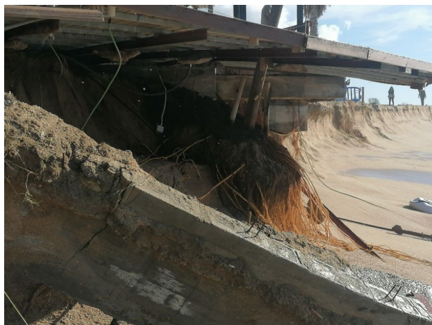
Imatge 19: Visió del col·lapse del mur de contenció i descalçament terrassa temporal i fixa. Data 02.04.2024.
