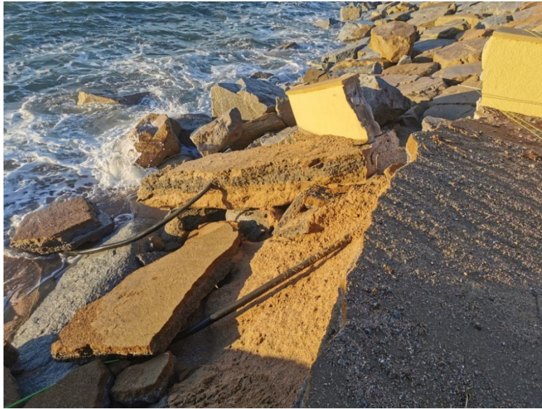
Imatge 20: Visió del col·lapse del mur de contenció del camí existent i d'accés al port. Data 02.04.2024.
