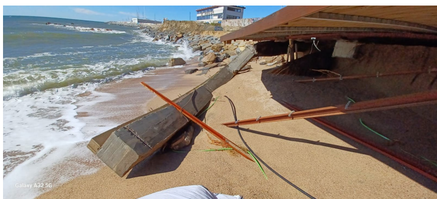
Imatge 18: Visió del col·lapse del mur de contenció i descalçament terrassa. Data 01.04.2024.
