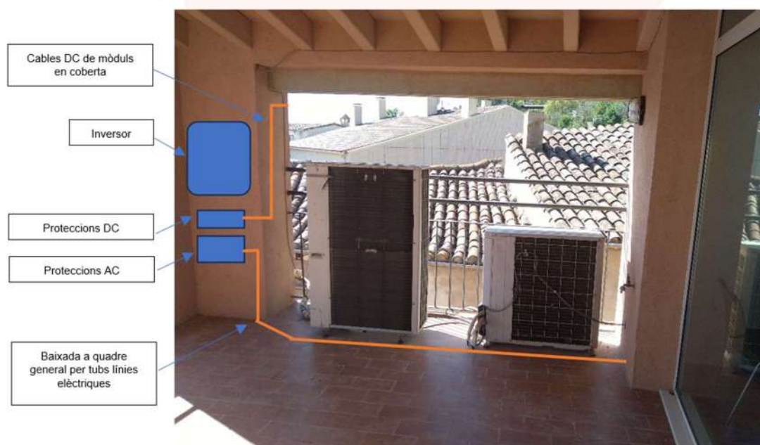
Imatge 6: Ubicació inversor FV
