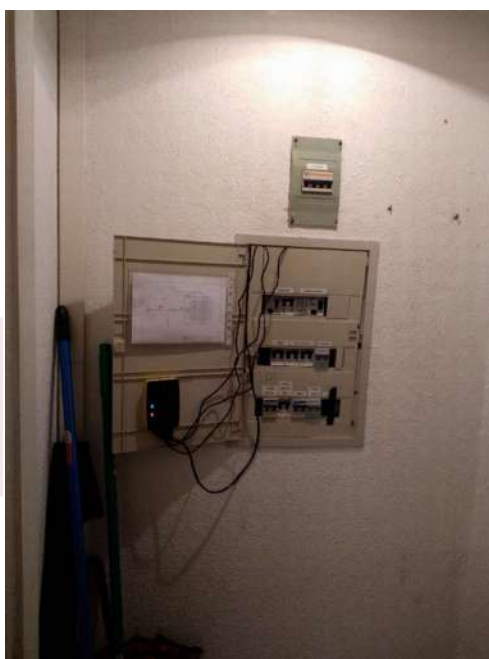
Figura 9. Quadre general de proteccions
