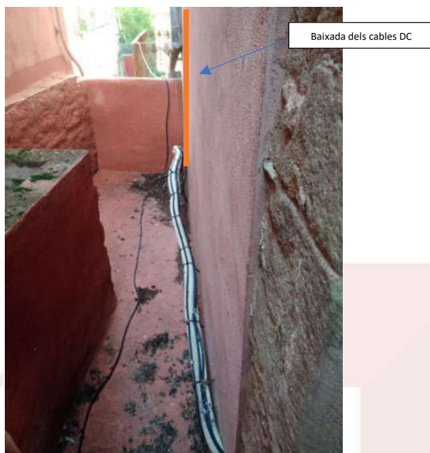
Figura 6. Cablejat del clima. Terrassa del primer pis.
