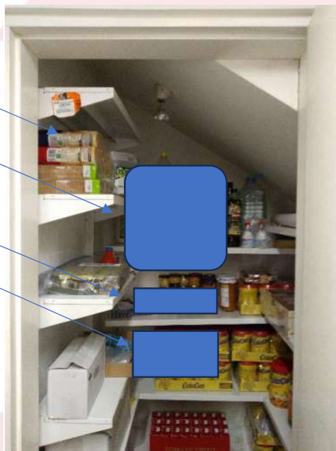
Ubicació inversor FV
