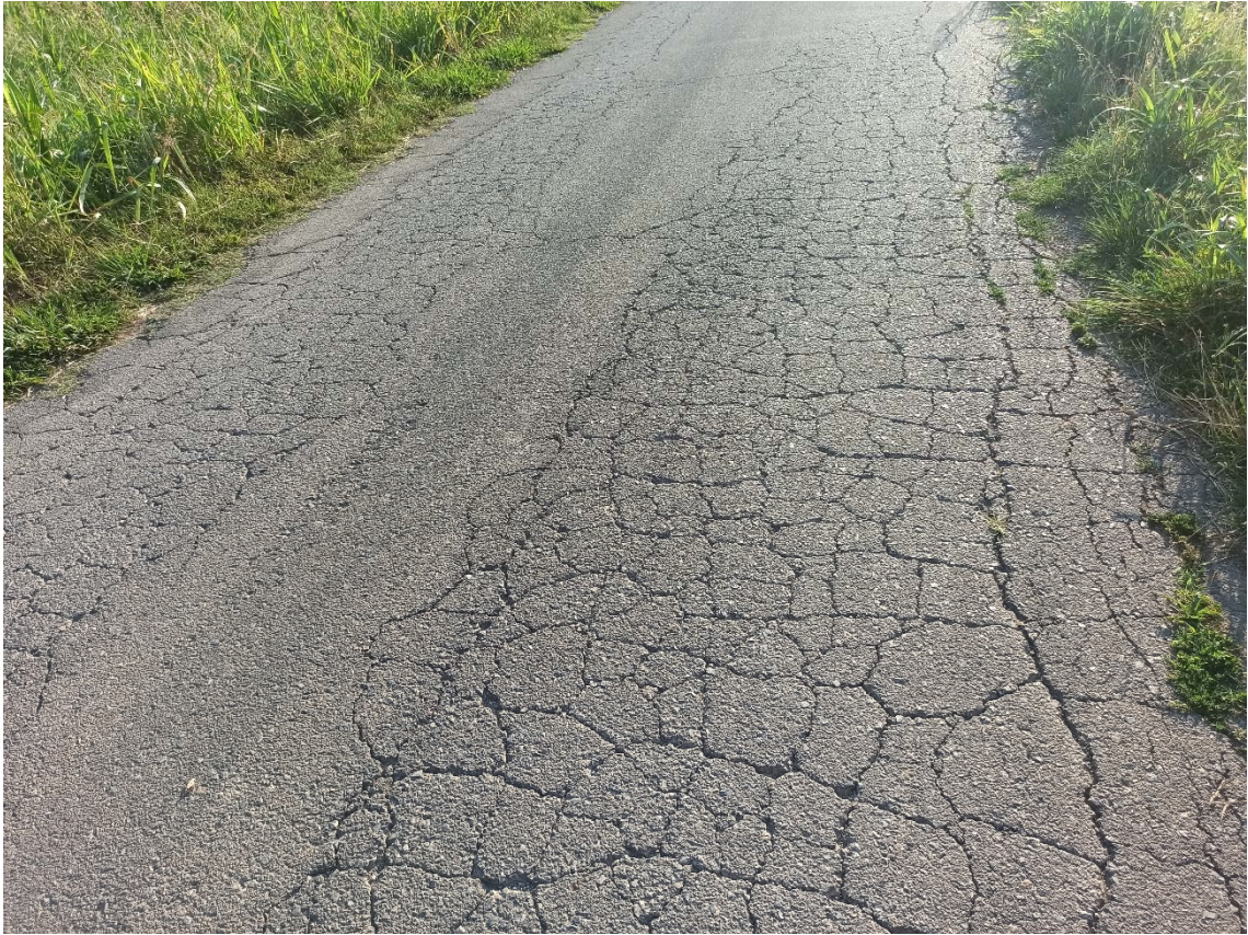
Tram asfalt fisurat
