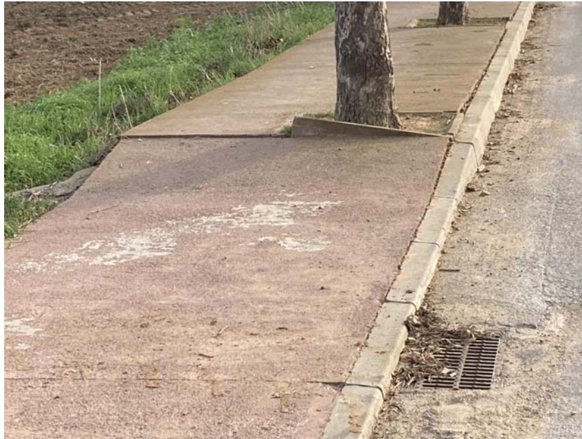
Imatge d'un altre tram de vorera. Paviment desnivellat i escossell aixecat
