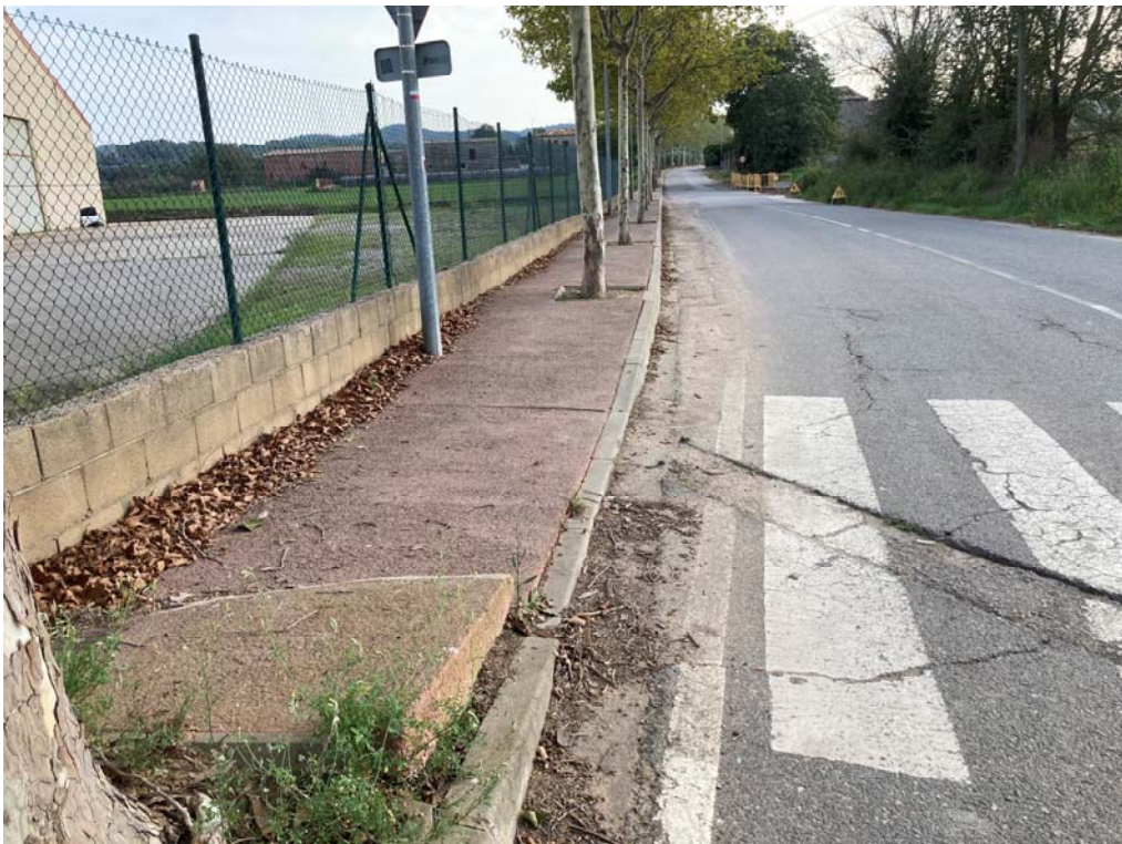
Vista de l'estat actual de la vorera amb el paviment de formigó aixecat També s'observen esquerdes en el paviment asfàltic de calçada
