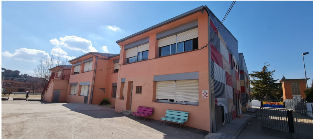
Façana est, a actuar totalment.
