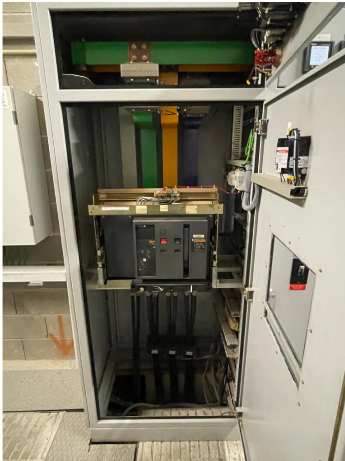
Imatge 2: Actual emplaçament de l'interruptor general del QGBT-B
