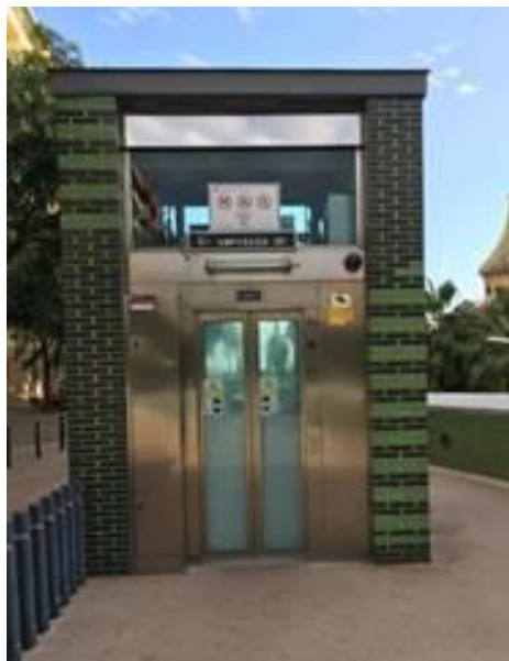
Fig. 3.- Ascensors amb senyalització descatalogada i en format adhesiu enganxat a l'edicle.
