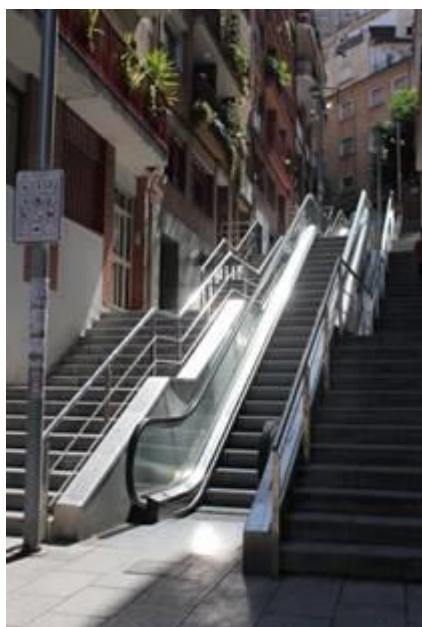
Fig. 1.- Escaleres mecàniques amb senyals descatalogades i suport no adequat. Panell informatiu LED inexistent.
