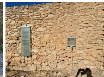
SENYALITZACIÓ FIXADA A MUR A RETIRAR
