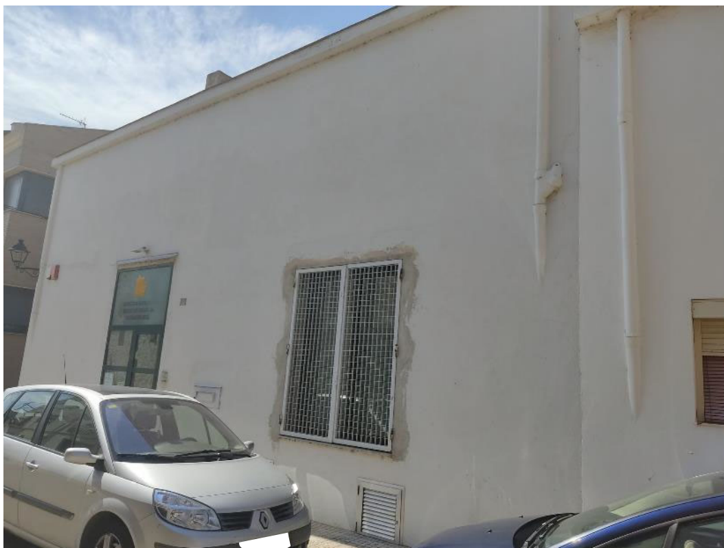
Vista de la portella d'accés a la sala d'instal·lacions. Per aquest punt entrarà la fibra òptica properament segons el desplegament que l'empresa pública TRAGSA fa als edificis i/o locals de la Generalitat de Catalunya
