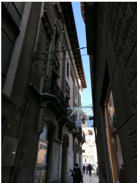
Imatges del cablejat aeri de baixa tensió al carrer de la Riera.
