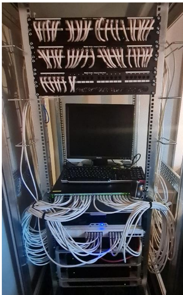
Imatge 10. Armari de comunicacions exclusiu cabines. En aquest armari estan inclosos els punts de xarxa de la nova instal·lació de l'AI2. Els punt de xarxa Ethernet dels ordinadors del docent de cada aula son a un altre armari de comunicacions, general UAB.
