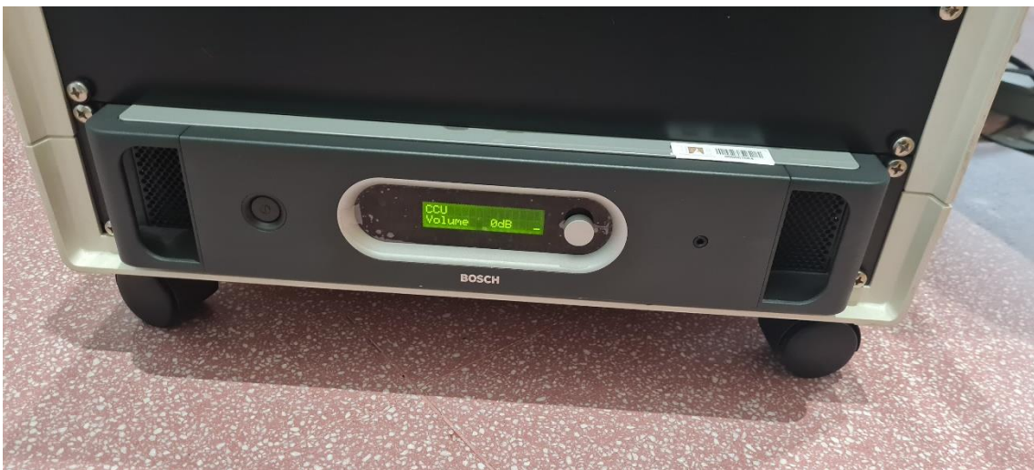
Imatge 13: Unitat de control BOSCH de les consoles de les cabines (aules d'interpretació 1 i 3)
