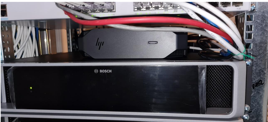
Unitats de control i gravació dels sistemes BOSCH i LABTRA.
