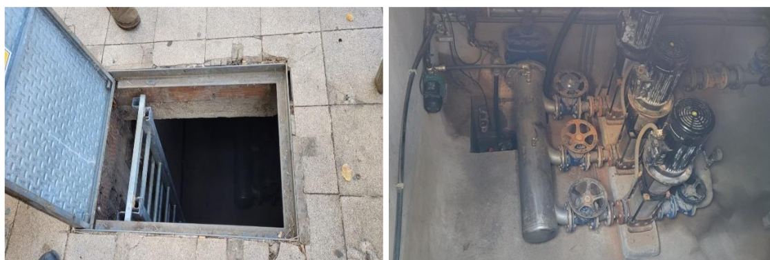
Figura 8. Estació de bombament del dipòsit. Entrada a la càmera seca i bombes
