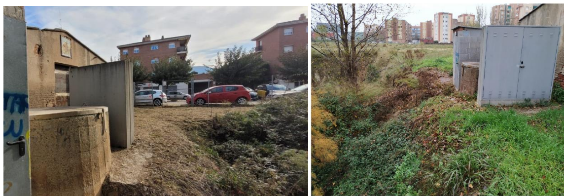
Figura 5. Deteriorament del recinte del Pou Passador. Font de la imatge de la dreta PD Abastament
