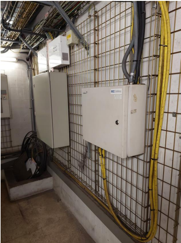
Situació actual del repartidor pk3 de paret al CCP
