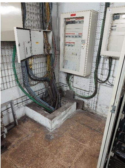
Situació actual del repartidor al CCP
