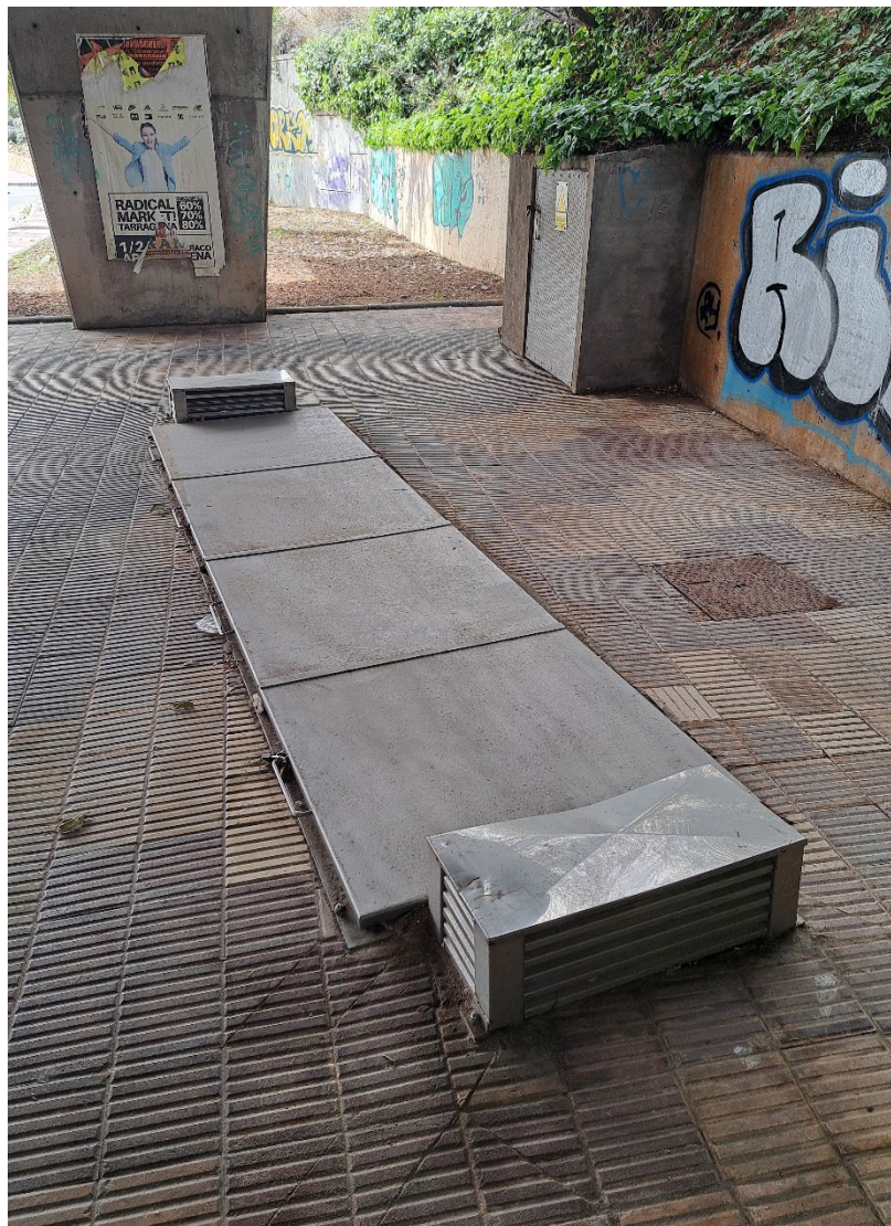
Foto Núm 4: Accés a la cambra seca de l'EB Miracle, on anirà una tapa assistida gran de varis mòduls per accedir a la instal·lació.
