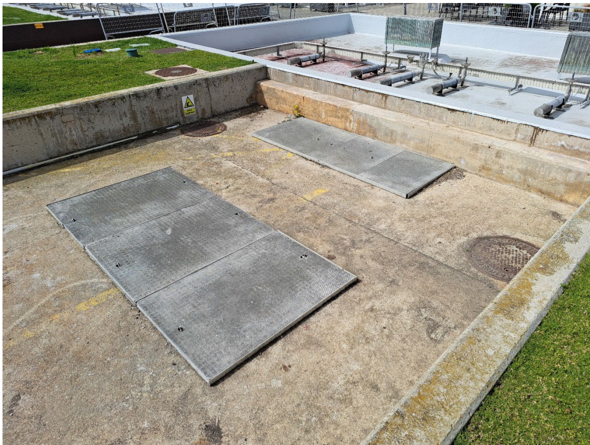
Foto Núm 1: Vista tapes accés a l'EB Serrallo.
