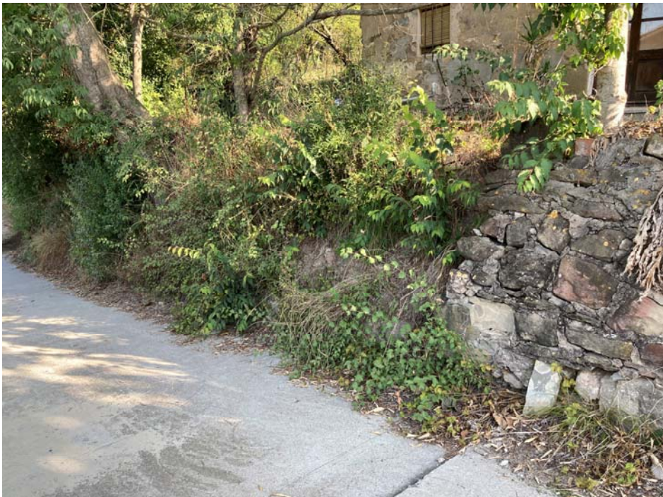
Imatge del talús a estabilitzar
