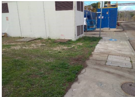
Arquetes MT al costat del gasòmetre i CT-COG-3
