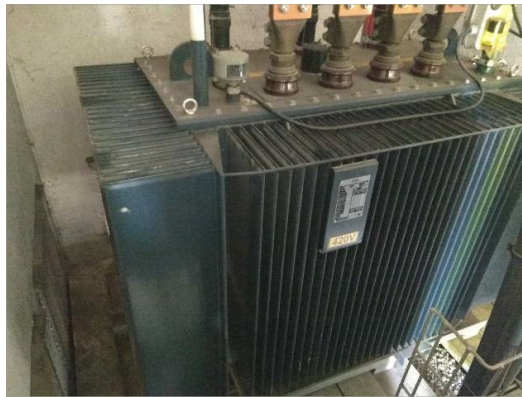
Cablejats de MT i BT, i transformador de distribució 1600 kVA
