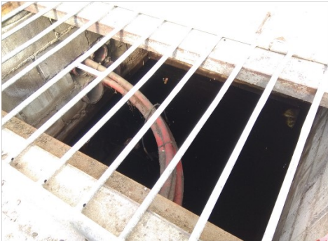
Arqueta MT al costat del CT-TRA-2
