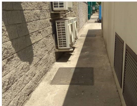
Arquetes BT darrere del CT-TRAT-2
