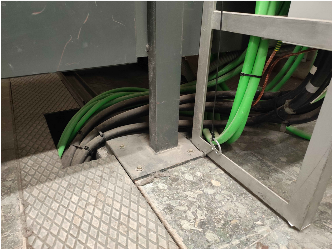
Cablejat a Quadres BT
