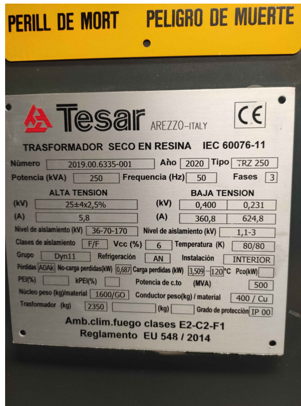
Placa trafo 250 kVA
