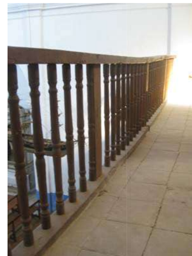
F3- FORJAT DEFORMAT
