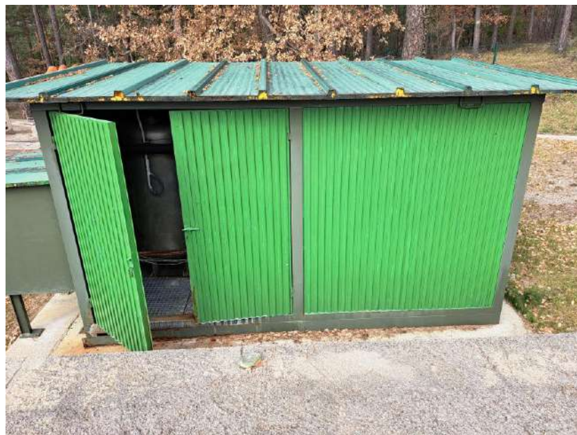
5. E.T.A.P. Subirà 1. Filtració
