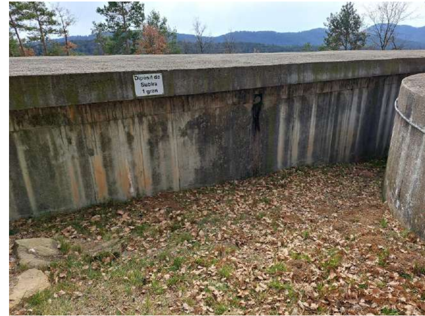
3. Dipòsit de Subirà 1 gran (aigua crua)
