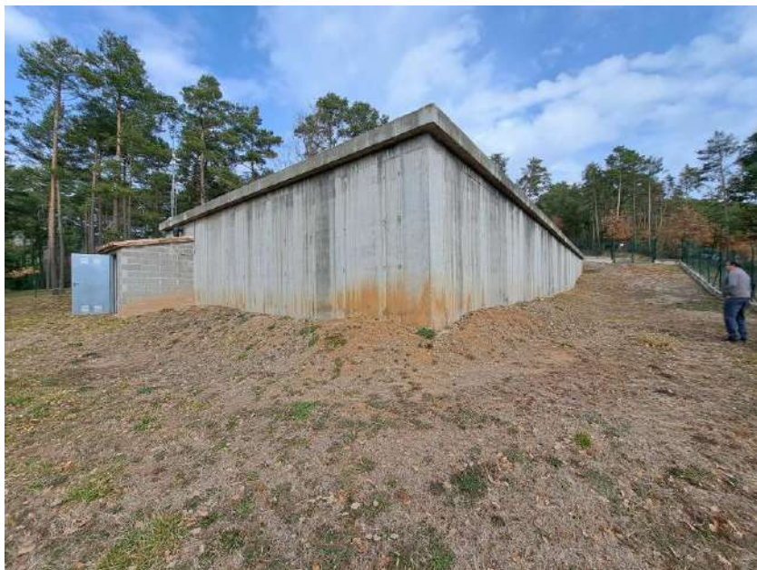
2. Dipòsit de Subirà 1 gran (aigua crua)
