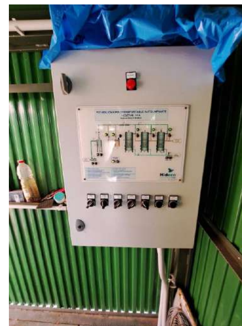
8. E.T.A.P. Subirà 1. Filtració
