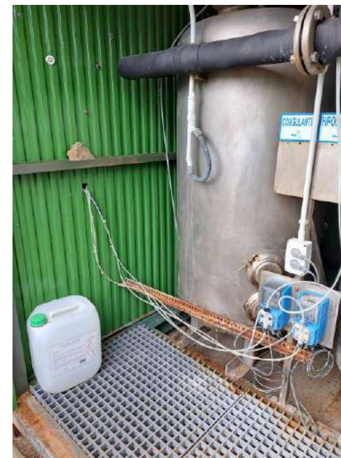
7. E.T.A.P. Subirà 1. Filtració
