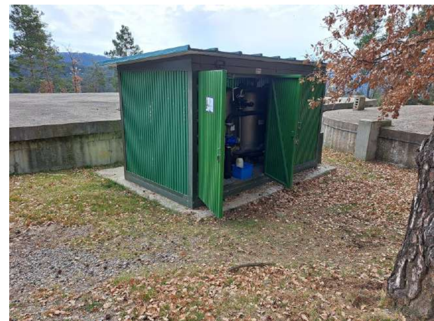
4. E.T.A.P. Subirà 1. Filtració
