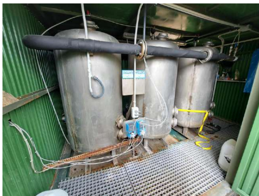
6. E.T.A.P. Subirà 1. Filtració
