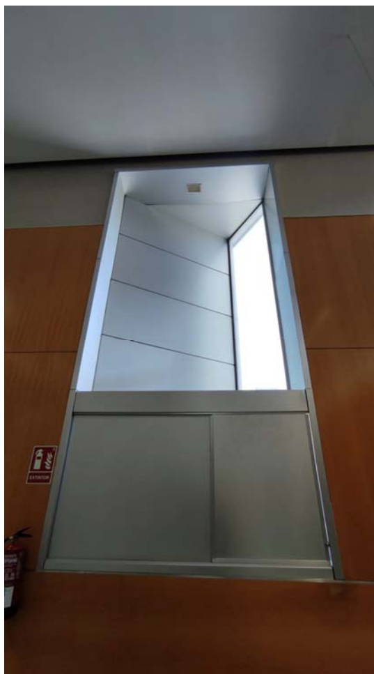
IMATGE HUMITAT I FILTRACIONS GALERIES TRIANGULARS
