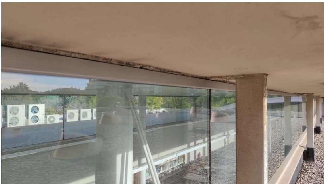
IMATGE ESTAT ACTUAL TROBADA ENTRE FUSTERIES EXTERIORS I RAPEC
