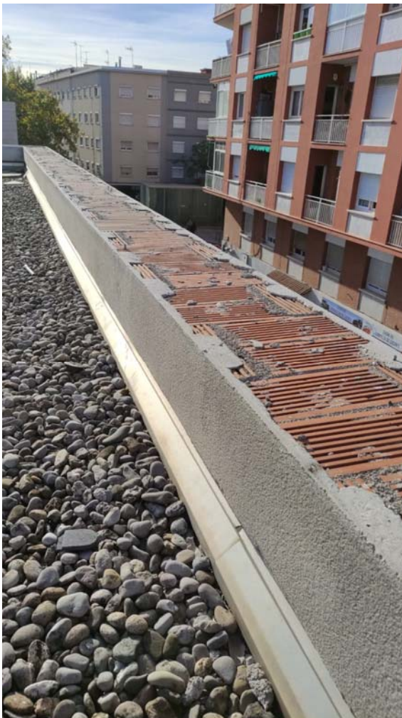
IMATGE ESTAT ACTUAL MURS PERIMETRALS SENSE XAPES DE CORONACIÓ
