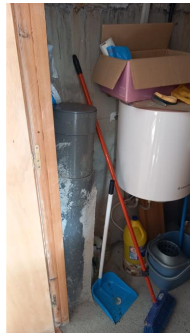
Punt de connexió sanejament.
