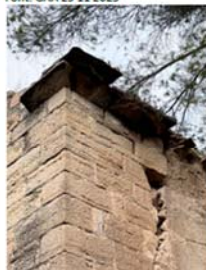
Degradació superficial de mènsula de pedra del ràfec de cantonada Font: GAA 29 11 2023
