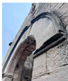
Erosió i degradació superficial i pèrdua de secció de la motllura de l'arquivolta i la imposta. Font: GAA 29 11 2023
