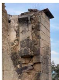
Presència de vegetació en el coronament del mur Font: GAA 29 11 2023
