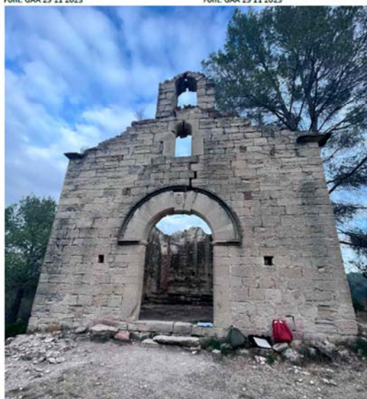
Presència de vegetació en el coronament de mur. Degradació superficial del material per presència d'humitats. Inestabilitat de l'arc de l'espaldanya. Font: GAA 29 11 2023
