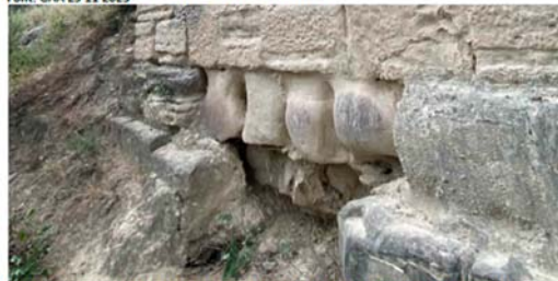
Degradació i pèrdua de carreus en la base del mur en contacte amb el terreny. Degradació superficial dels carreus de pedra. Rentat de Junts. Font: GAA 29 11 2023
