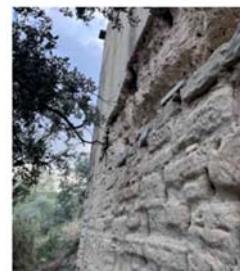
Degradació superficial dels carreus de pedra. Rentat de Junts. Font: GAA 29 11 2023
