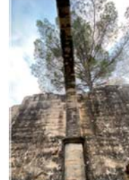
Degradació superficial dels carreus, brutícia i ennegriment Font: GAA 29 11 2023
