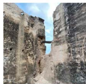
Restes d'intervencions i actuacions preexistents, restes de l'obertura de migdia i erosió tàpia Font: GAA 29 11 2023
