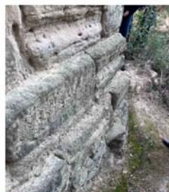
Presència de vegetació en la base de la façana i patina biogènica. Font: GAA 29 11 2023
