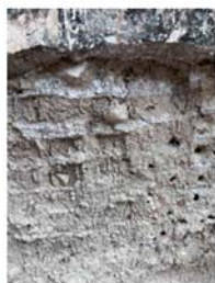
Degradació superficial i erosió en la massa del mur de tàpia. Font: GAA 29 11 2023
