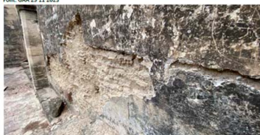
Degradació en la base del mur de tàpia sobre la bancada de carreus de pedra. Despreniment del revestiment de morter de calç. Font: GAA 29 11 2023
