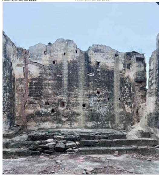
Sals, brutícia superficial i ennegriment i activitat vandàlica en el parament. Desprement revestiment de la tàpia i degradació per l'acció de l'aigua al coronament del mur. Presència de vegetació Font: GAA 29 11 2023
