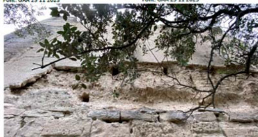
Degradació en la base del mur de tàpia sobre la bancada de carreus de pedra. Despreniment del revestiment de morter de calç i pèrdua de massa del mur. Font: GAA 29 11 2023
