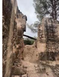
Ensulsiat parcial del tram del mur de la obertura de migdia. Degradació tram inf. Font: GAA 29 11 2023
