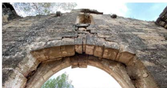
Pèrdua de junts entre els dos fulls de façana de carreus de pedra treballats, esquerdes i fissures. Desprement d'elements. Presència de sals i eflorescències als paraments. Font: GAA 29 11 2023
