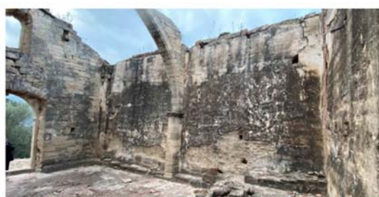
Presència de vegetació en el coronament dels murs. Sals, brutícia superficial i ennegriment i activitat vandàlica en el parament. Despreniment revestiment de la tàpia, degradació en la base del mur. Font: GAA 29 11 2023
