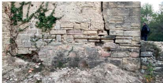
Vegetació enfiladissa en el mur de façana, arrelada en la base de carreus de pedra, desprendiment de carreus. Erosió superficial de carreus de la bancada i vegetació en el interior. Pèrdua de trava. Font: GAA 29 11 2023
