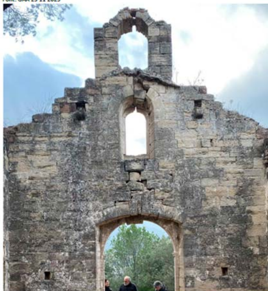
Presència de vegetació en el coronament dels murs, restes de la coberta de teula àrab. Inestabilitat de dovelles dels arcs d'obertures. Sals, brutícia superficial i ennegriment del parament. Font: GAA 29 11 2023
