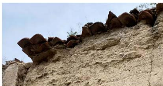
Restes del ràfec de coberta inclinada de teula àrab compost de volada de tres nivells. Font: GAA 29 11 2023
