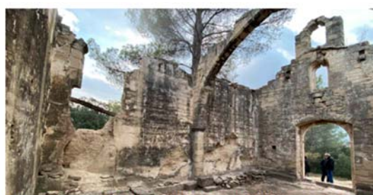
Despreniment revestiment de la tàpia, degradació en la base del mur i en el coronament. Pèrdua de material en el coronament de l'arc central, pèrdua de compressibilitat de les dovelles. Inestabilitat. Font: GAA 29 11 2023
