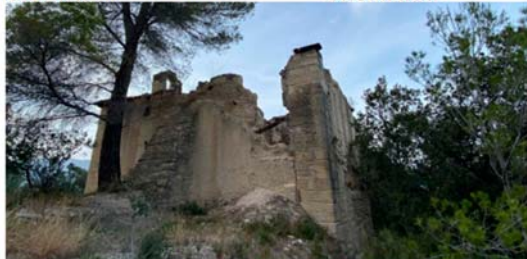
Degradació del coronament del mur de tàpia. Desprendiment del revestiment de morter de calç i pèrdua de massa del mur per l'acció de l'aigua. Font: GAA 29 11 2023
