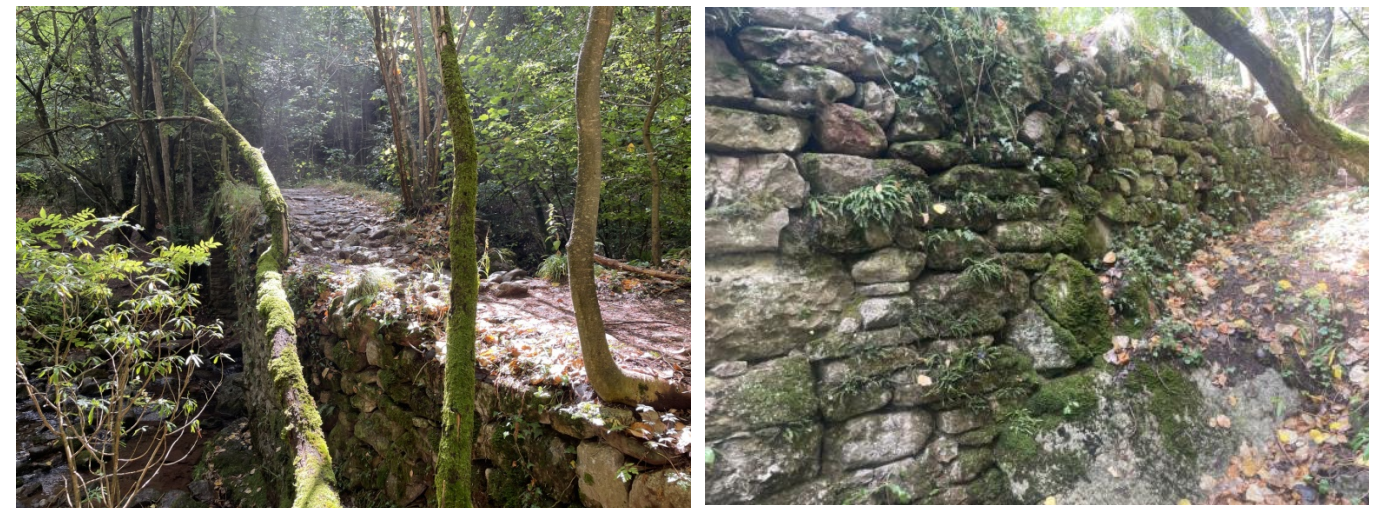
Arbres de les vores i arrelats sobre la sola del pont. Molses adherides a les pedres del costat d'aigües amunt.
