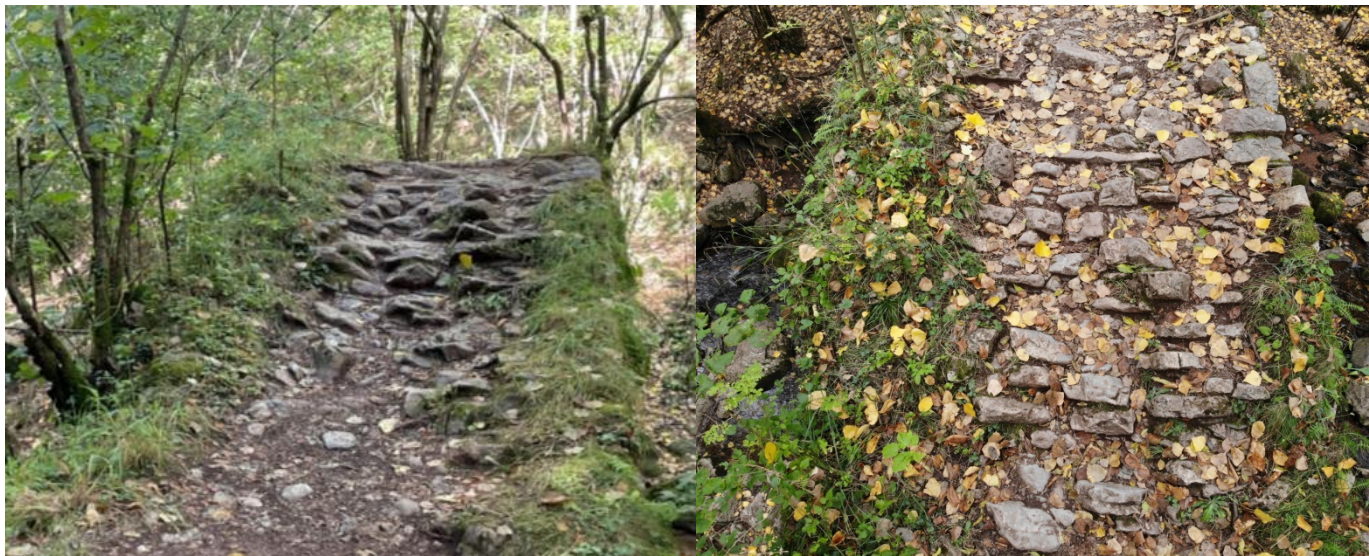
Estat de la sola del pont al costat de llevant on s'ha perdut la rasant original i han aflatat l'intradós.
