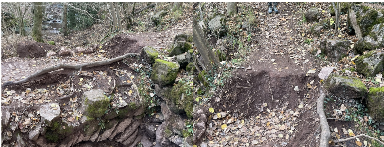
Estrep de ponent. Reblert de terres sobre la sola i arrels superficials que oculten el paviment original
