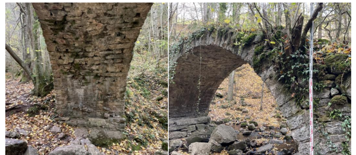
Paraments de l'intradós de la volta, i arbres crescuts i desprendiments puntuals de pedra al capçament dels murs
