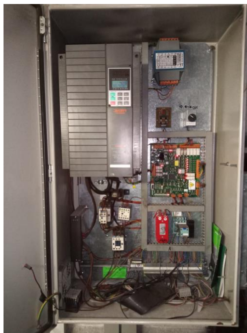
Quadre control actual dret
