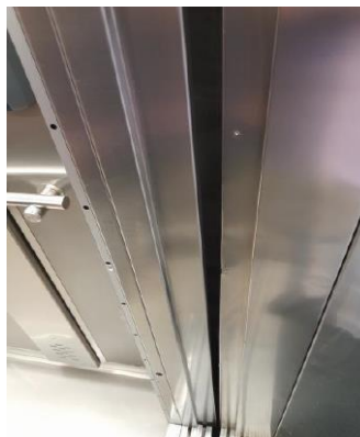
Desplom actual de la cabina
